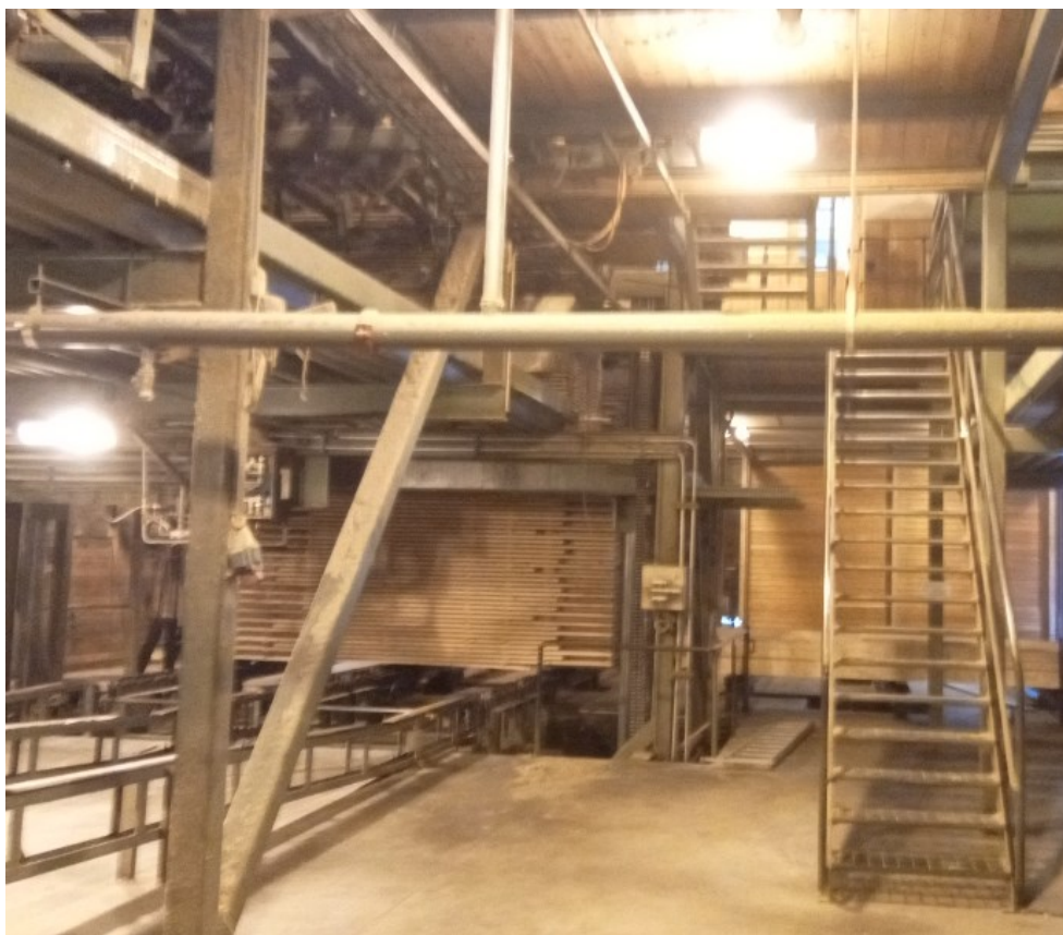
Kuva 17. Vanhan rimoituksen alakerran nykyinen valaistustilanne. (Topi Venäläinen, 2021)
