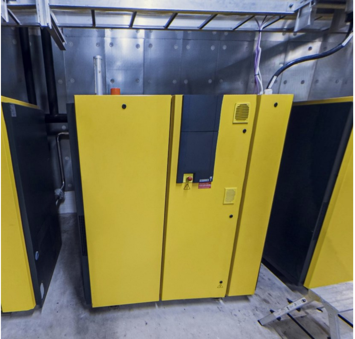
Kuva 2. Instrumentti-ilmakompressori (Turun seudun puhdistamo Oy 2021).
