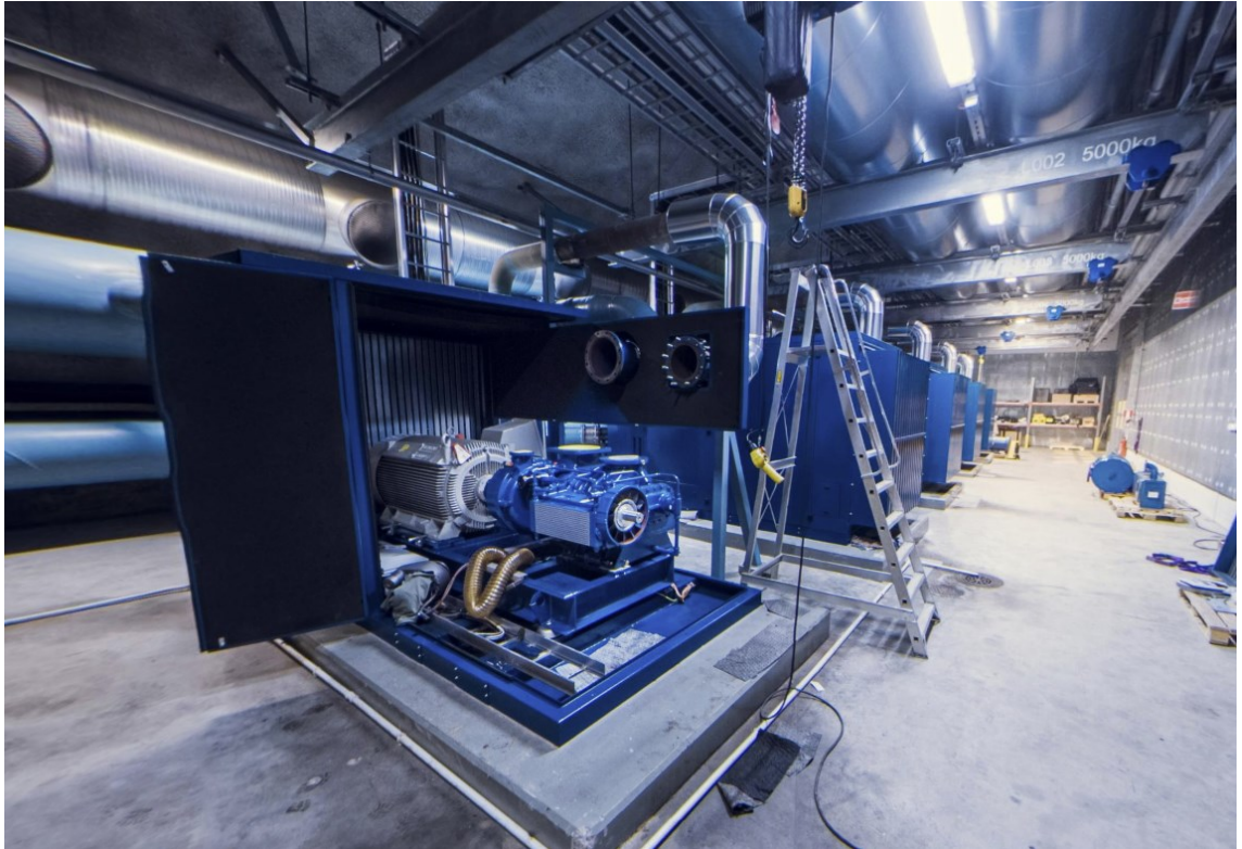
Kuva 3. Kompressoritila ja ilmastusilmakompressorit (Turun seudun puhdistamo Oy 2021).
