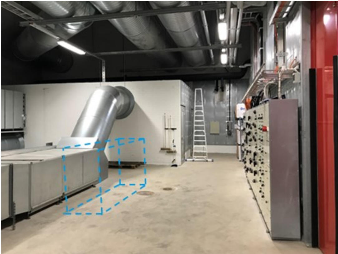
Kuva 10. Tuloilmakonehuone (Turun seudun puhdistamo Oy 2021).
