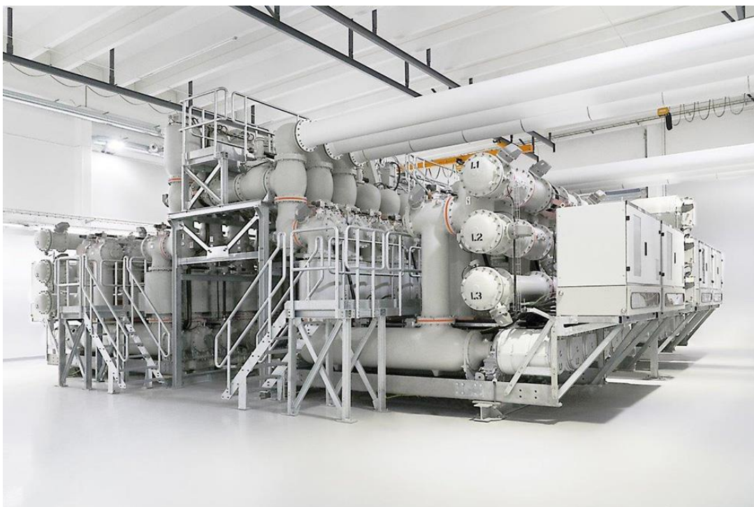
KUVA 3. Fingridin Länsisalmen 400 kV GIS-kojeisto. (ABB 2019)
