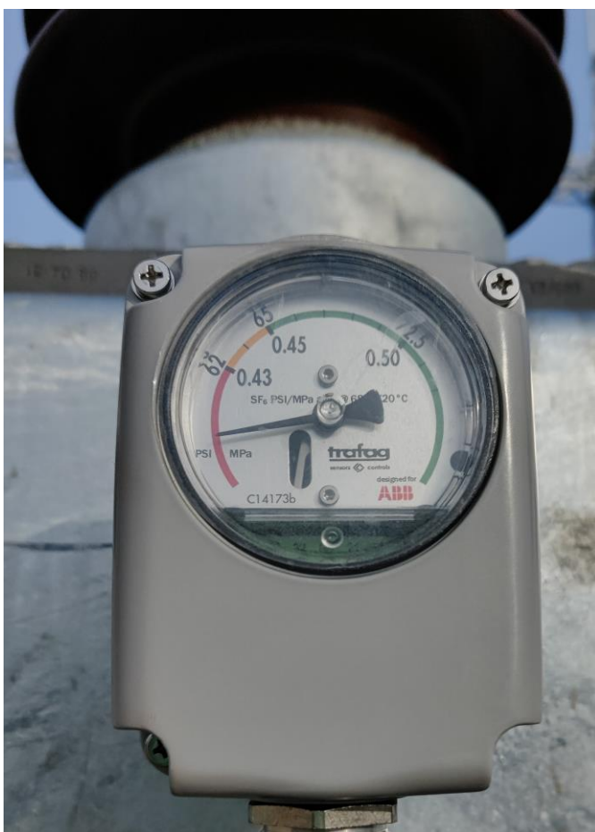
KUVA 5. Katkaisijan kaasun tiheysvahti
