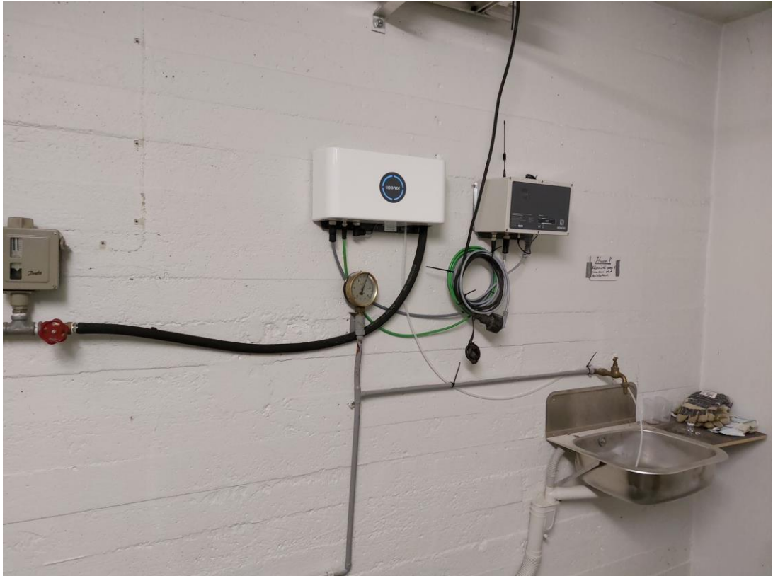
Kuva 3: Uponorin laitteisto valmiiksi asennettuna Mustakallion paineenkorotus- asemalla.
