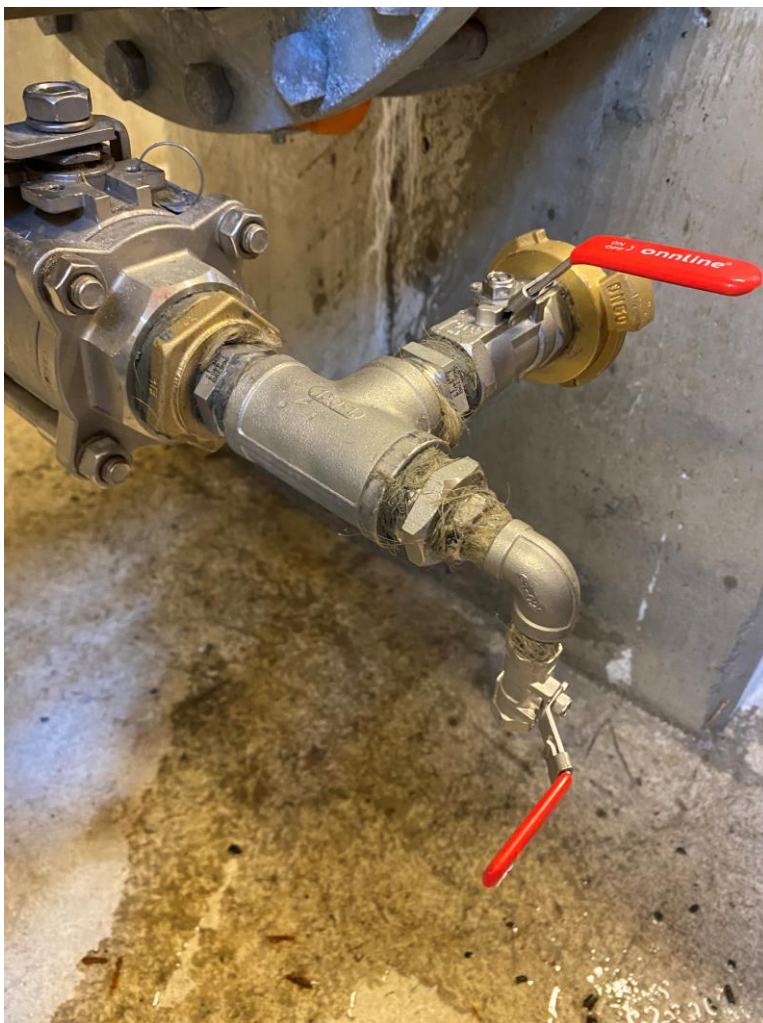
Kuva 8: Löyttymäen supistettu putkiyhde ennen laitteen asennusta. Alempi hana on asennettu laitteen käyttöön.
