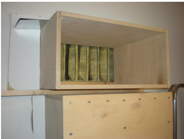
KUVA 6. Ilmanottoaukko ja suodatin. Kuva: Anna Kälkäjä
