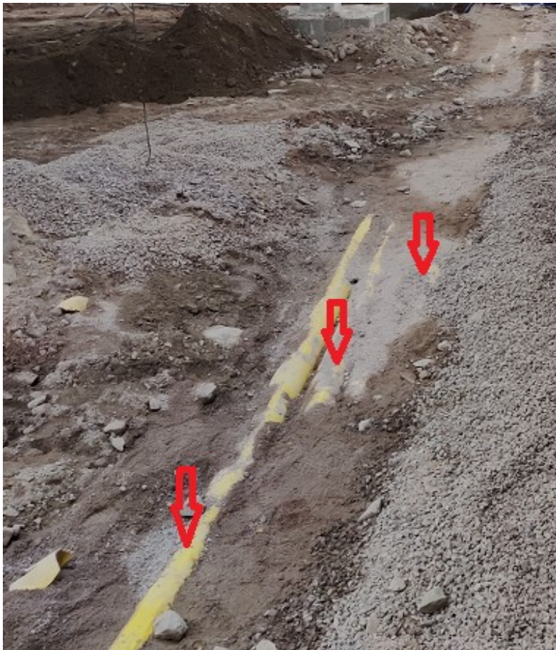
Kuva 12. Mitattavat kaapelin suojaputket
