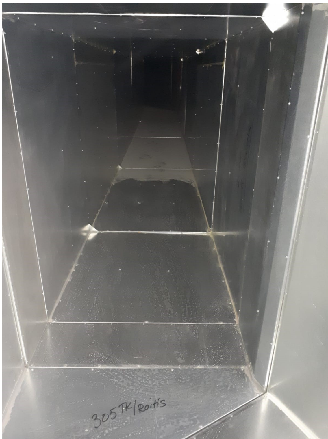
Kuva 13. Ilmanvaihtokanavistoa tarkasteltaessa havaittiin epäpuhtauksia.
