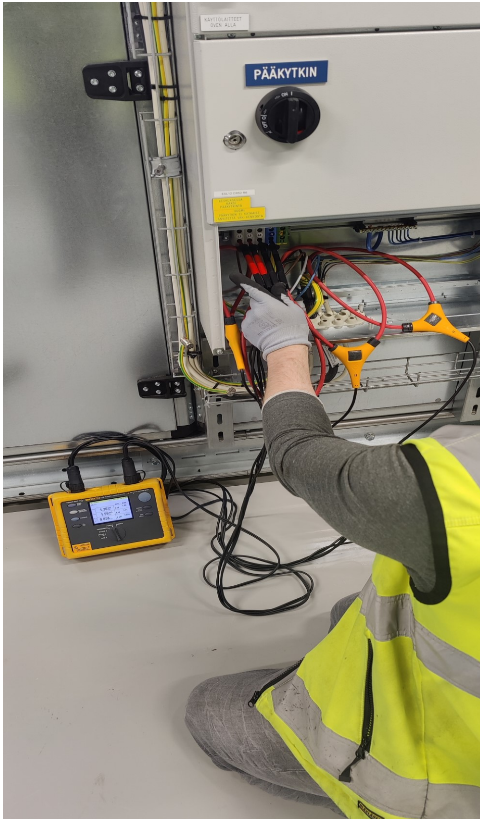
Kuva 21. Ilmanvaihtokoneen ottama sähköteho mitataan Fluken dataloggerilla ilmanvaihtokonekohtaisesta sähkökeskuksesta.
