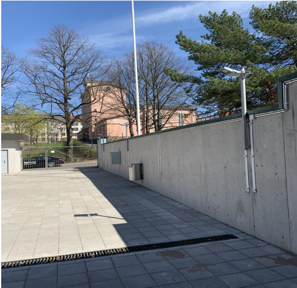
Kuva 8. Muurin ylös nostetut valaisimet.
