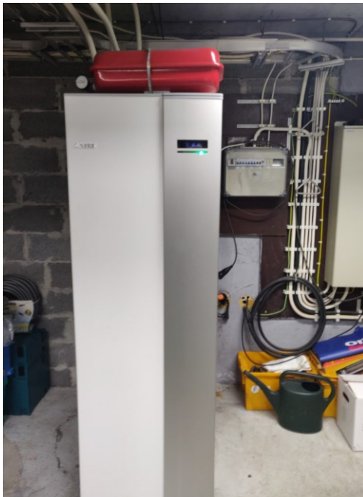
Kuva 13. Nibe F1245 -mallin lämpöpumppu teknisessä tilassa.
