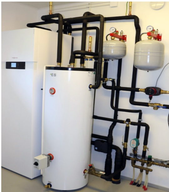
Kuva 4. Omakotitaloon asennettu maalämpöpumppu sekä rinnalle kytketty lämmityspiirin puskurivaraaja [7]. (LVI-nero)
