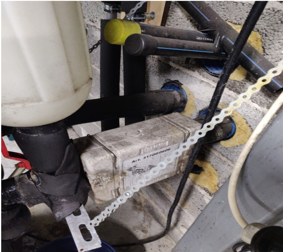
Kuva 12. Siirtoputket energiakaivoilta maalämpöpumpulle sekä lämmönkeruunestesäiliö.
