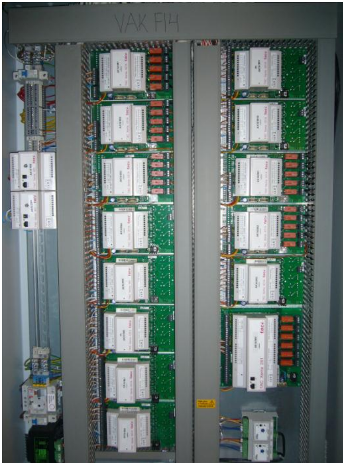
Kuvio 3. Kuva alakeskuskaapin sisältä Seinäjoen keskussairaalassa
