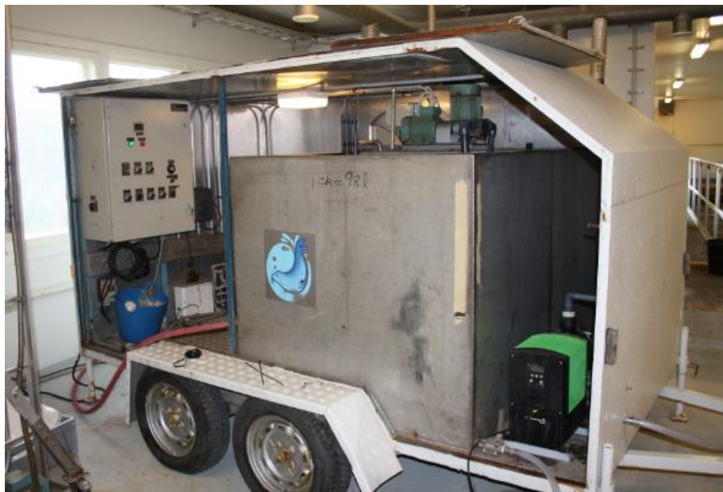
Kuvio 16. Kemiran Reposaaressa toimittama syöttölaitteisto.
