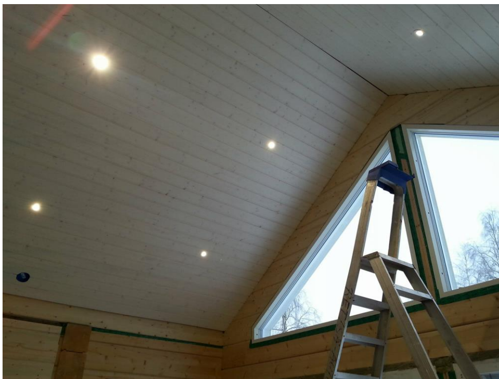
Kuva 20 Olohuoneen upotetut kattovalot
