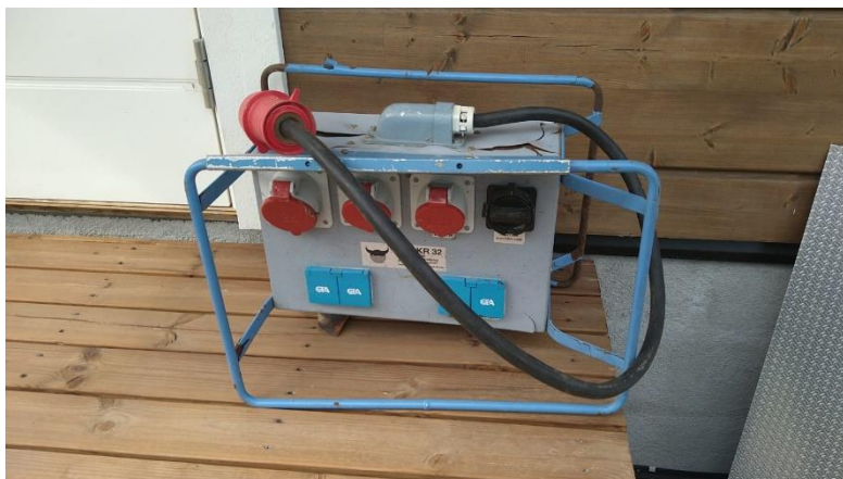
Kuva 9 Pieni 3-vaihe työmaakeskus
