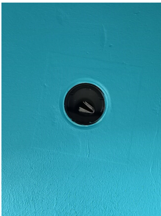
Kuva 16. Vedeneriste lattiakaivon ympärillä.
