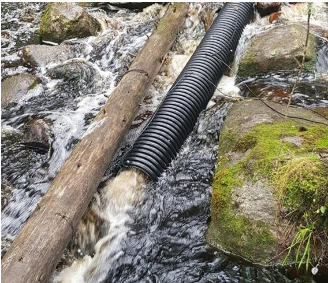
Kuva 19. Waterlily turbiinit rumpuputken sisällä uomassa. (Kuva: Tino Jehkonen).
