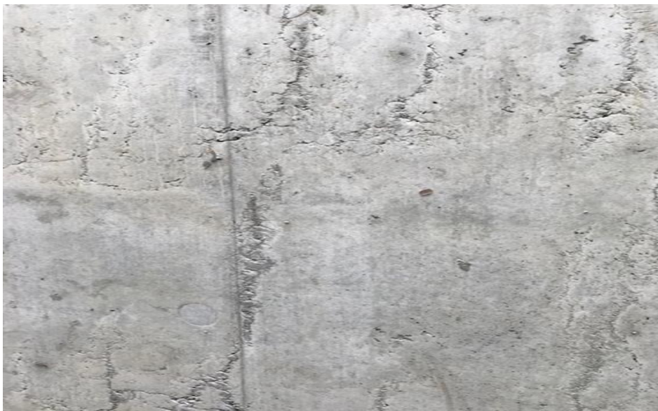
KUVA 15. Erottunutta kiviainesta seinärakenteessa (Ruuskanen 2021)
