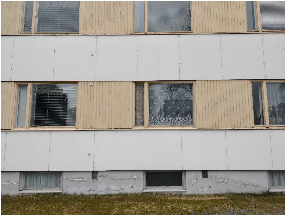
KUVA 6. Julkisivu länteen, paneeliseinien ja ikkunapellitysten vauriot (Tynkkynen 2020, CC BY-SA)
