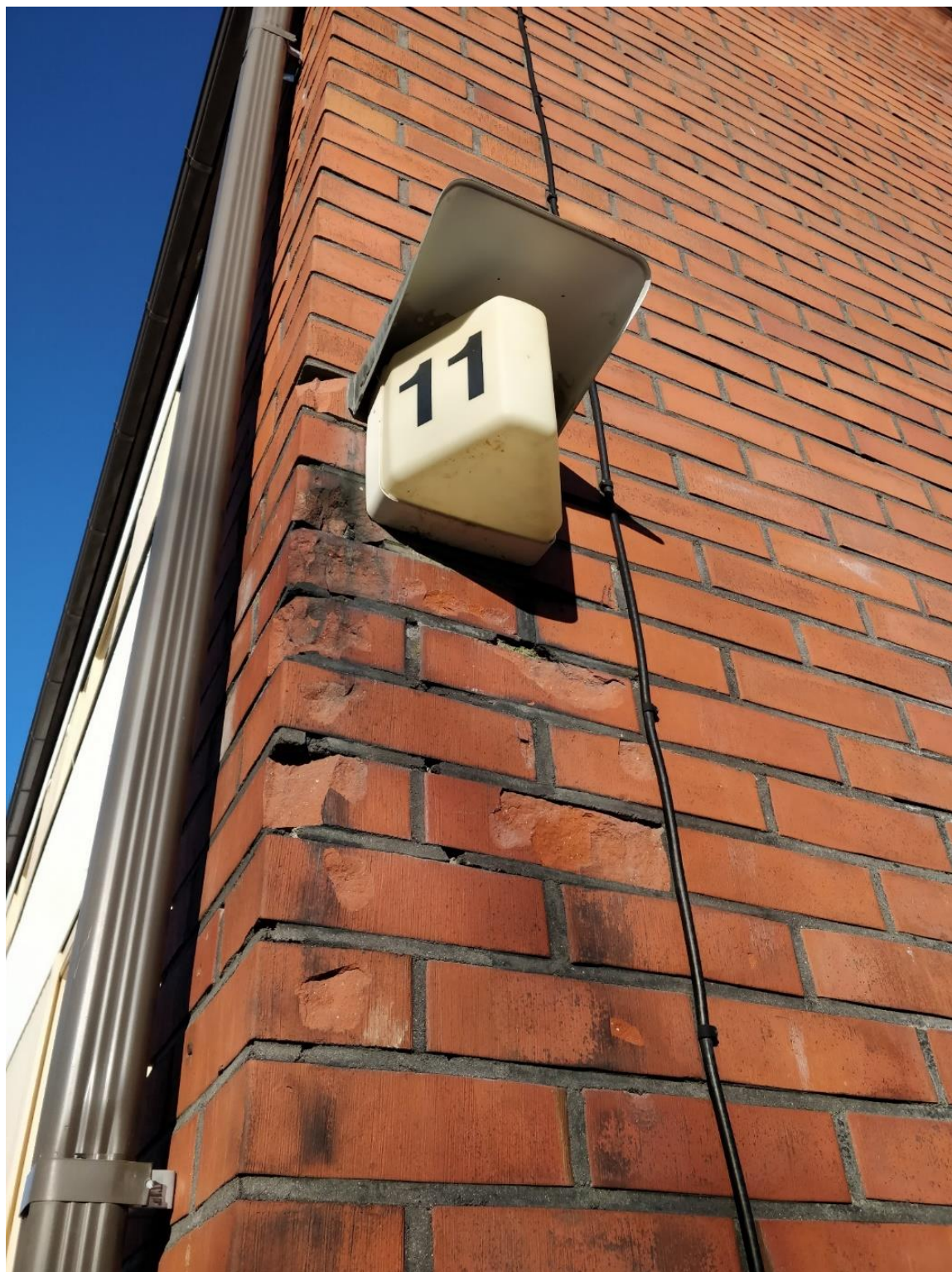
KUVA 5. Julkisivu etelään, tiiliseinän halkeamat (Tynkkynen 2020, CC BY-SA)
