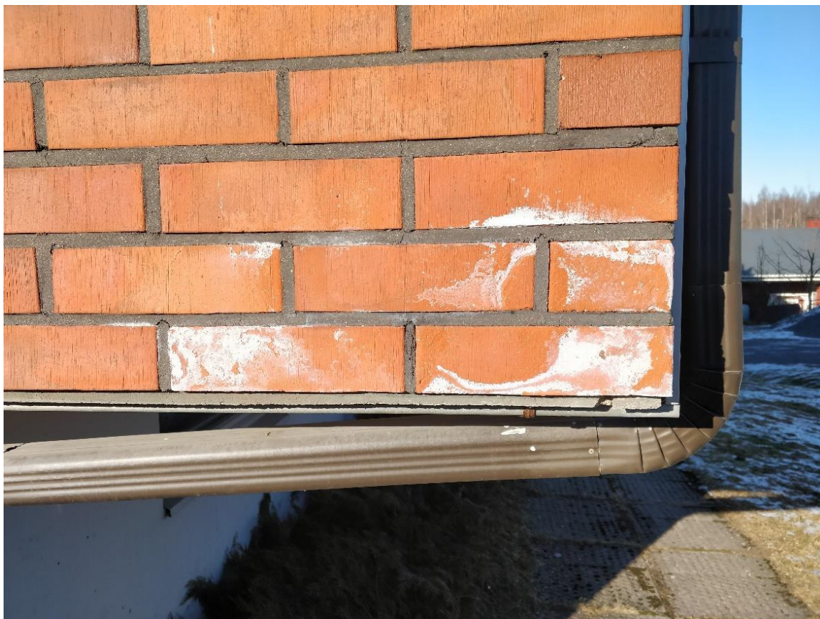
KUVA 4. Julkisivu etelään, tiiliseinän kalkkeumat (Tynkkynen 2020, CC BY-SA)
