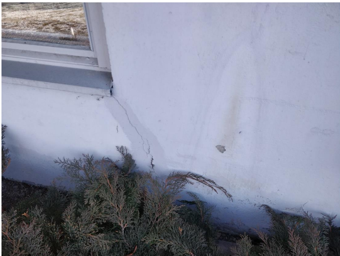
KUVA 3. Julkisivu itään, halkeamat sokkelipinnassa (Tynkkynen 2020, CC BY-SA)
