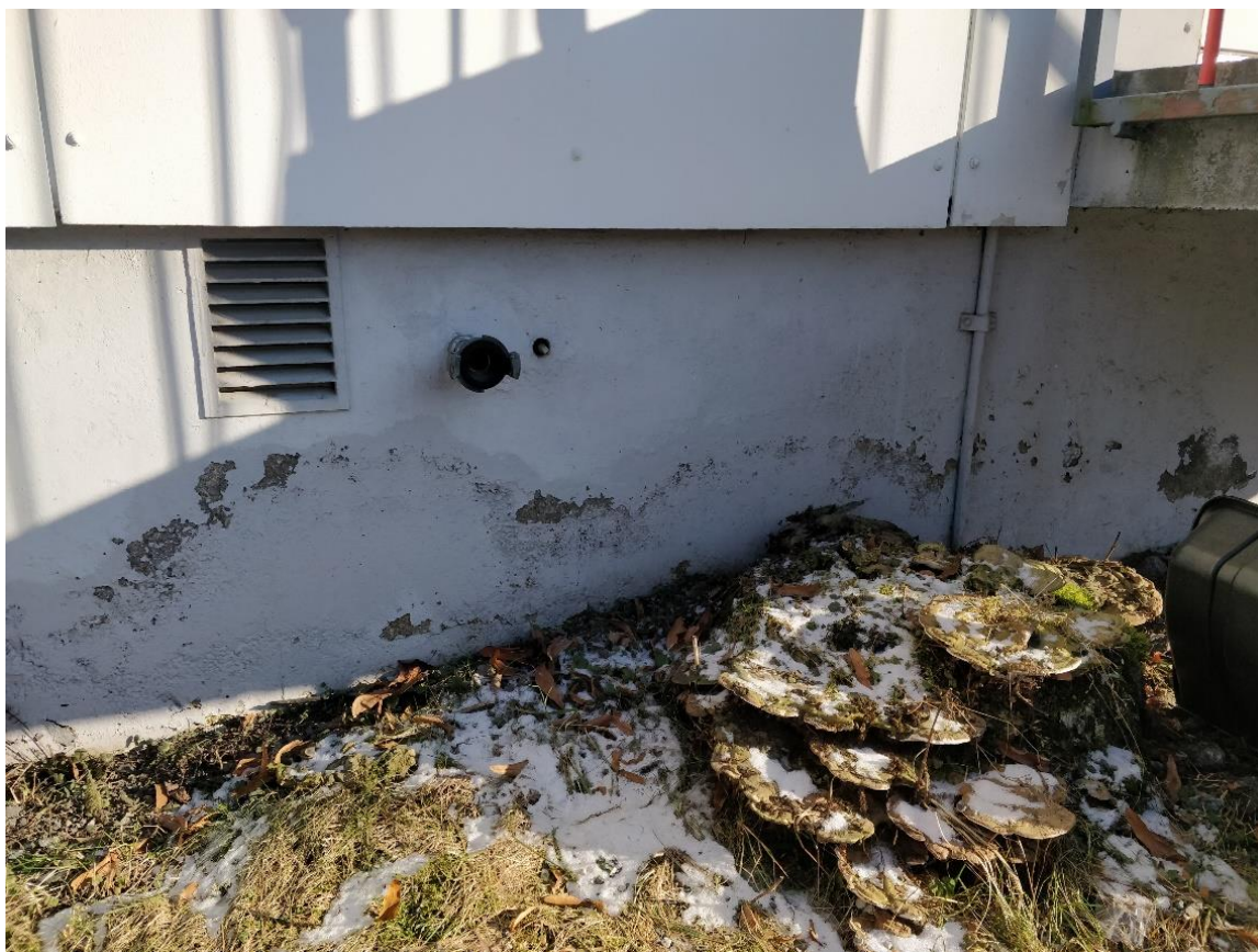
KUVA 2. Julkisivu länteen, sokkelin maalipinnan haurastumat ja halkeamat (Tynkkynen 2020, CC BY-SA)
