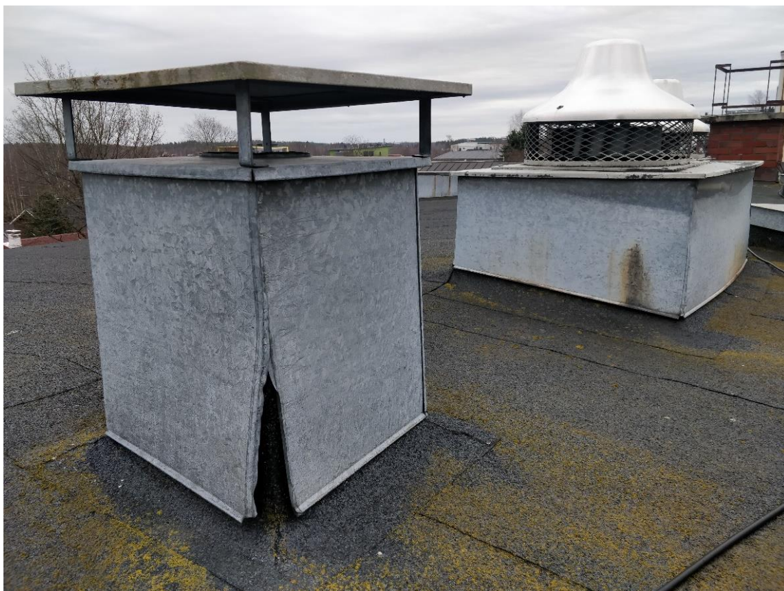
KUVA 8. Vesikatteen kasvusto ja hormiston sekä kattolaitteiden vaurioituneet pellitykset (Tynkkynen 2020, CC BY-SA)
