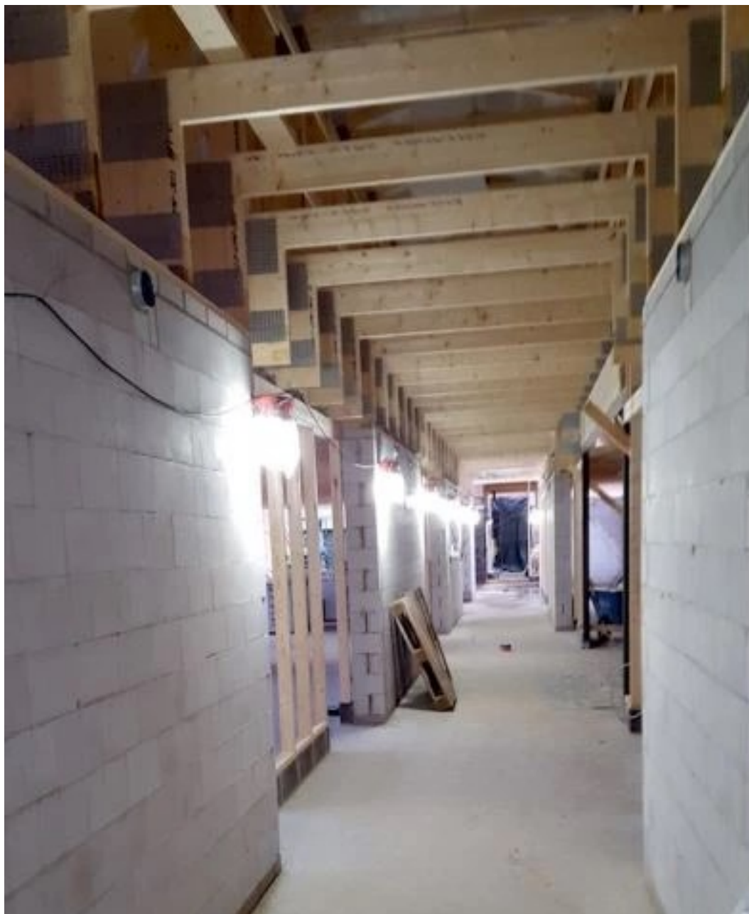
KUVA 6: Ketjutettavat työmaavalaisimet asennettuna. (BAU-MET Oy 2021)
