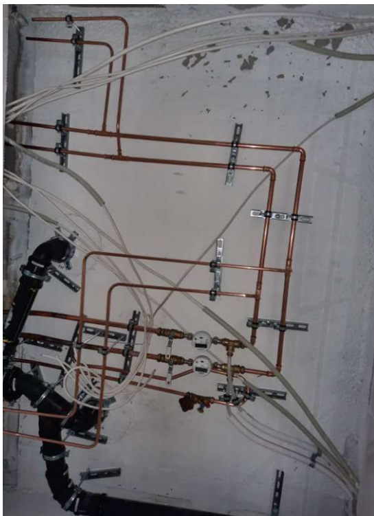
Kuva 11. Kylpyhuoneen alakaton yläpuolelle piiloon jäävät viemäri- ja vesijohtohajotukset.
