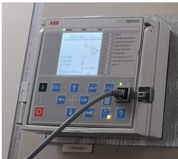
Kuva 3. ABB REF615 -kennotermiäli.
