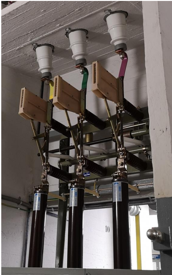
Kuva 1. 24 kV varokekuormanerotin vanhassa betonikennokojeistossa
