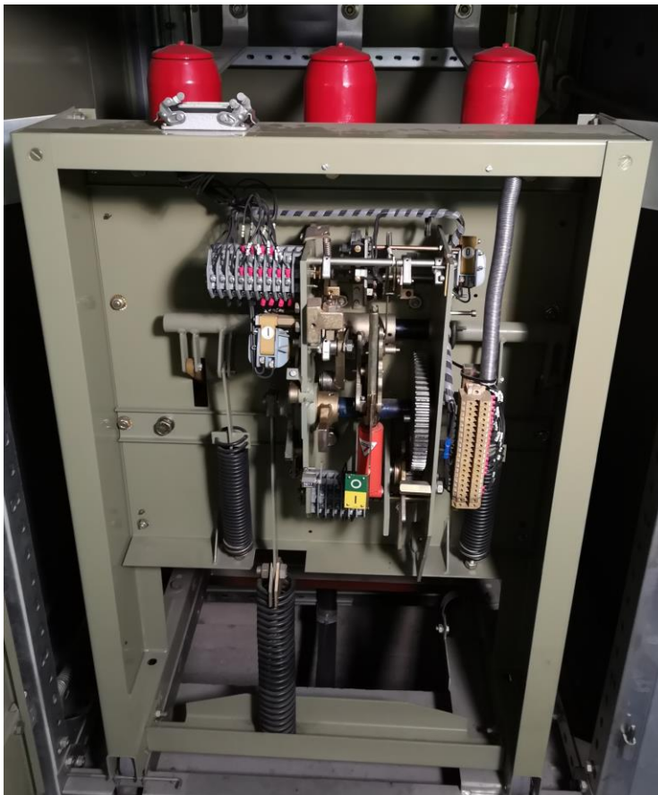
Kuva 2. Strömbergin vähäöljykatkaisija ohjaimen kansi avattuna.
