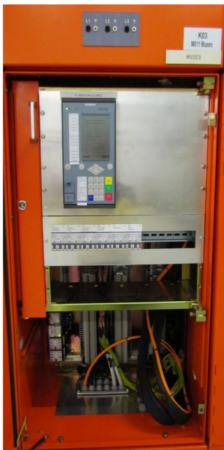
KUVA 17 Siemensin suojarle SIPROTEC 7SJ82 eräällä kj-lähdöllä (Kuopion Sähköverkko Oy 2021)
