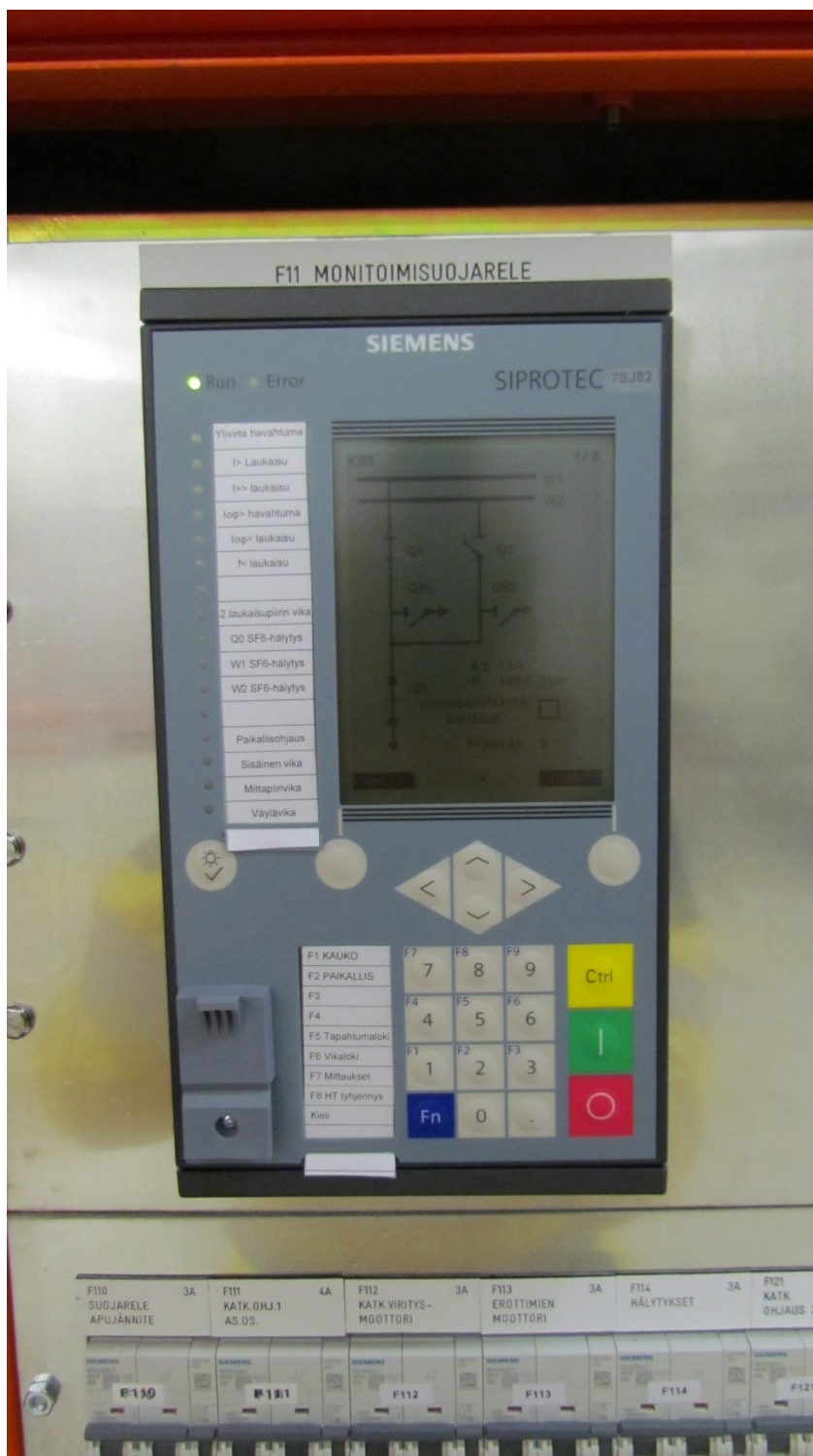
KUVA 18 Siemens SIPROTEC 7SJ82 suojarile (Kuopion Sähköverkko Oy 2021)
