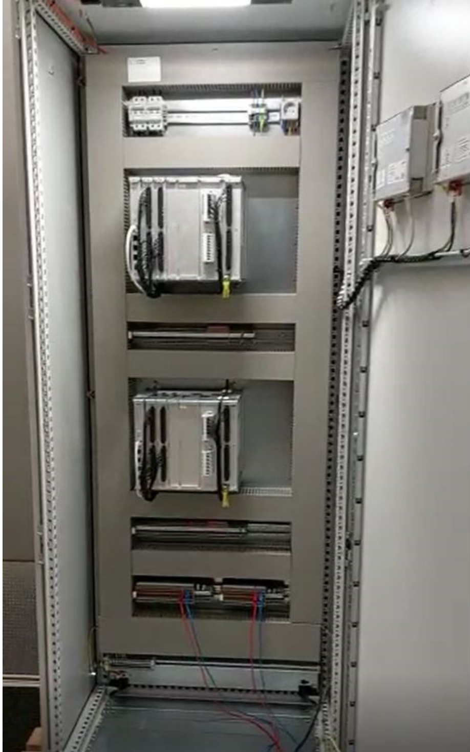
KUVA 14 Keskitetyn johtojärjestelmän laitekaappi (Energineering Oy)
