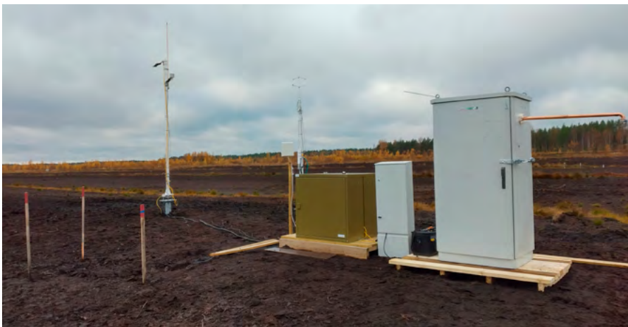
Kuva 5. Naarasnevan mittausasema valmiina (kuva: Kari Laasasenaho)
