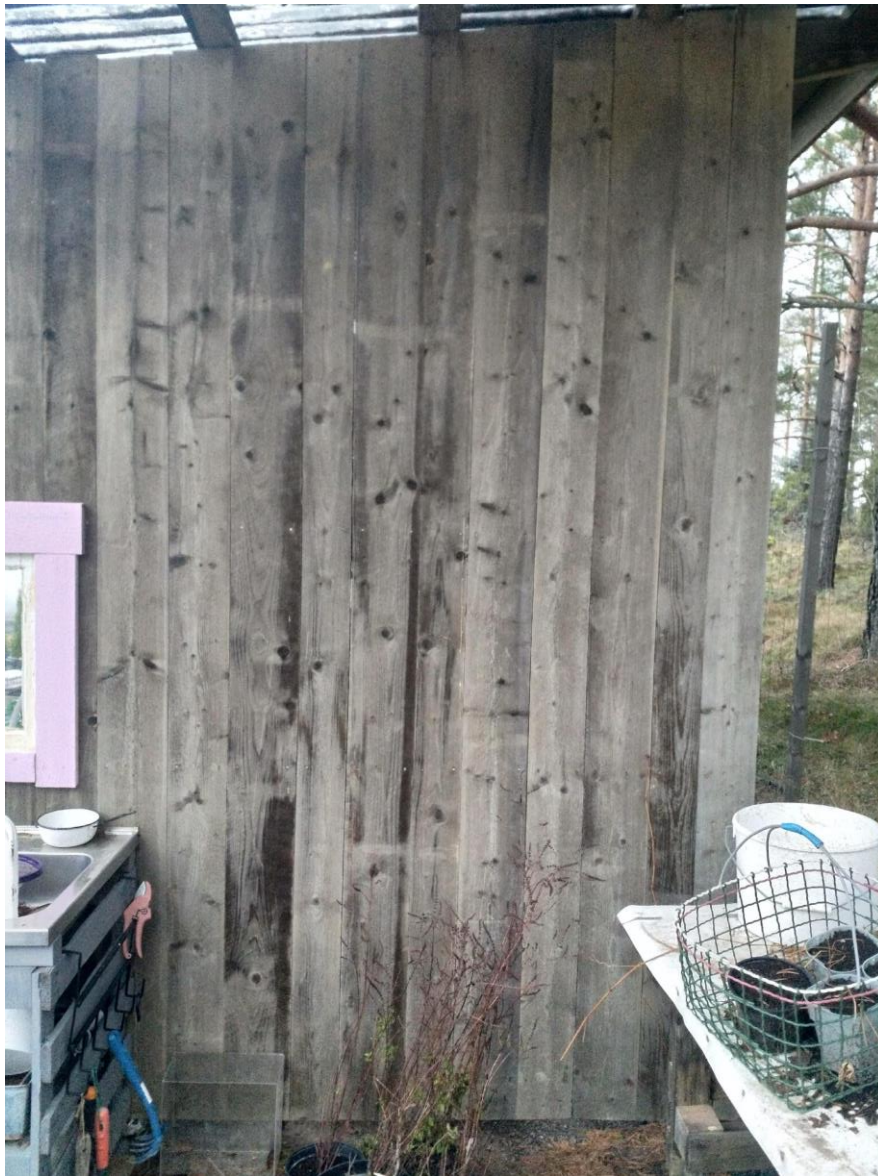
Figur 6. Järnvitriolbehandlad vägg, foto taget en fuktig dag och därmed syns mörka fläckar. (Foto: Dennis Björkqvist, 2021)
