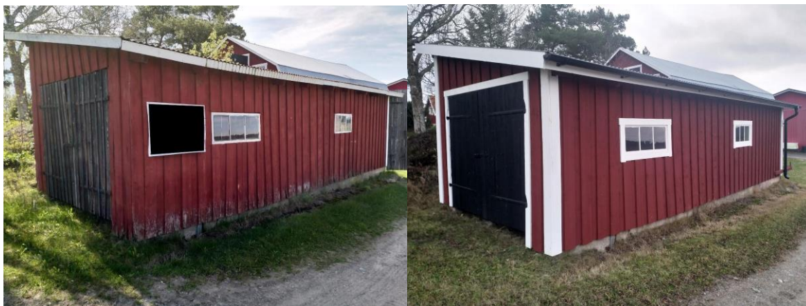
Figur 18 och 19. Vänster bild (Figur 18), tak utan takrännor har bräderna skadat hela vägen längs med marken. (Foto: Dennis Björkqvist, 2020). Höger bild (Figur 19), alla brädor byts nya och takrännor monterades. (Foto: Dennis Björkqvist, 2021)
