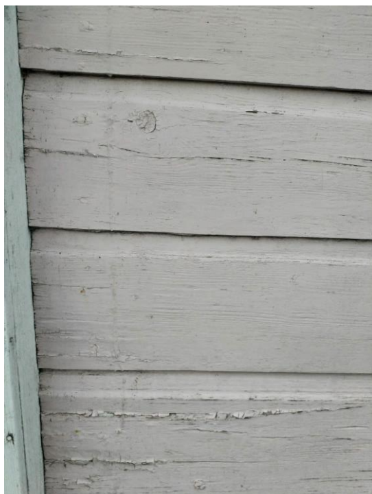
Figur 9. Sprickor i träunderlaget, samt sprickor i ytfärgen var den också börjat flagna. (Foto: Dennis Björkqvist, 2021)
