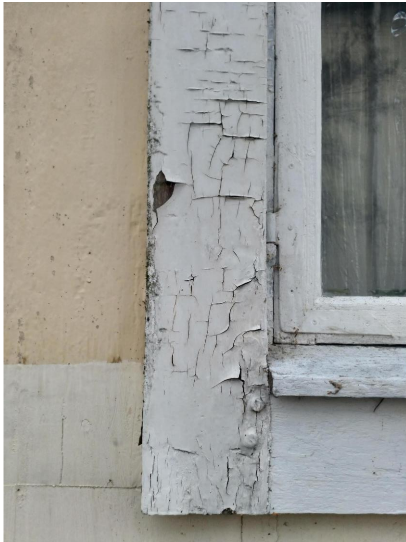
Figur 11. Flagning i fönsterfoder var färgbitar börjat lossna. (Foto: Dennis Björkqvist, 2021)
