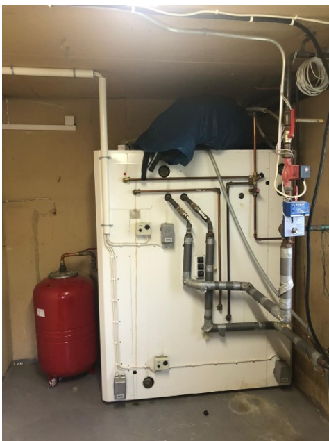
Kuva 10. Kuva kohteen lämminvesivaraajasta ja laitteistosta.
