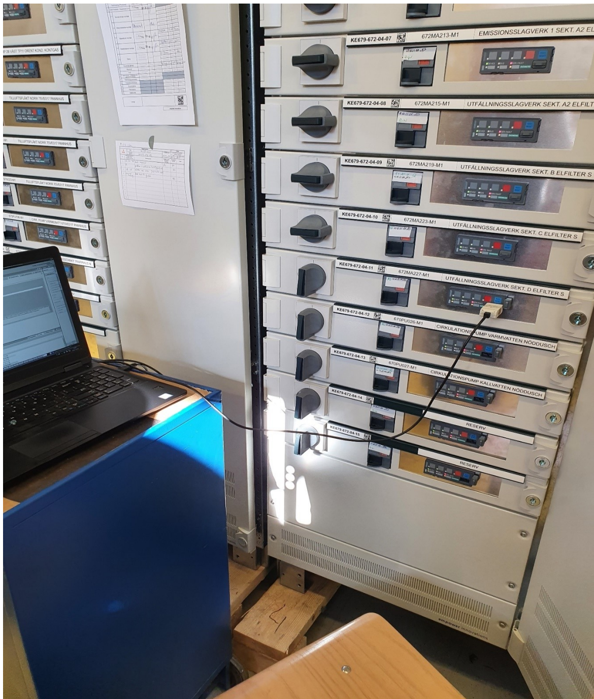
KUVA 11. Testiohjelman asentaminen logiikoille
