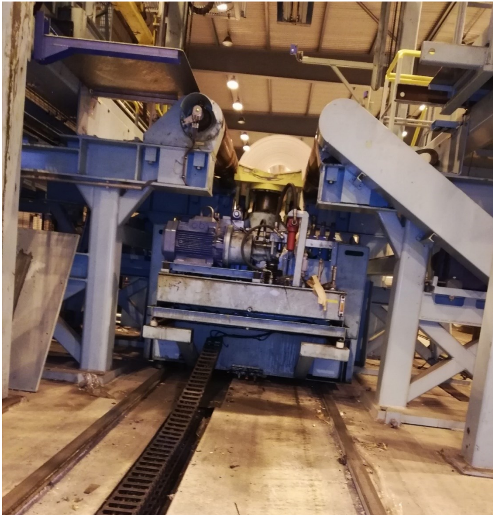
Kuva 44. Käärintälinja 1:n siirtovaunu
