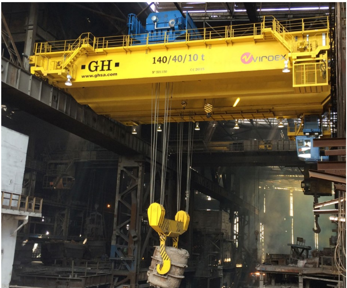
Kuva 3. Siltanosturi terässulatolla (GH Cranes & Components 2021)
