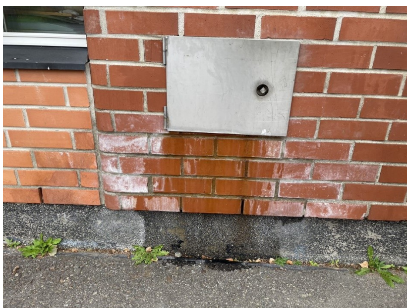
(Kuva 6. Palopostin kastuneet tiilet ja sokkeli)
