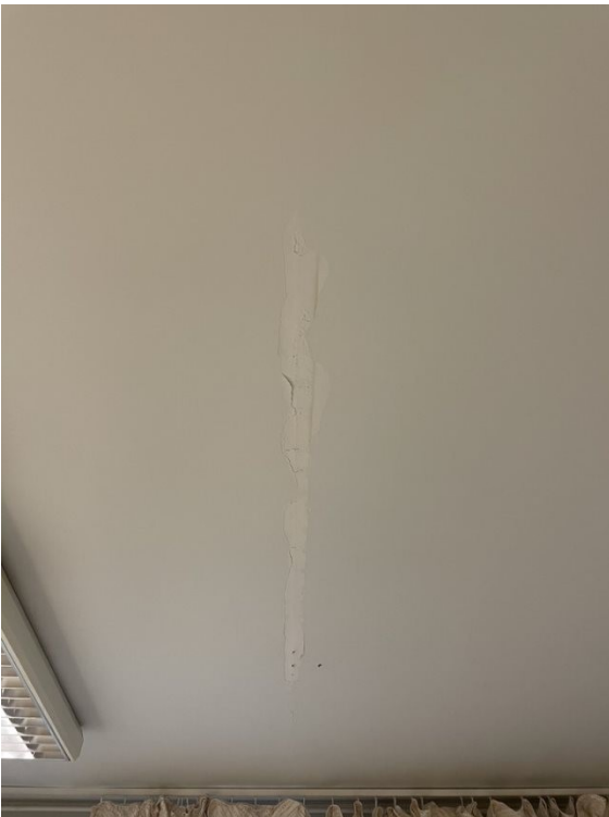
(Kuva 17. Toimistotilan alakatossa jo korjatun kattovuodon aiheuttama jälki)
