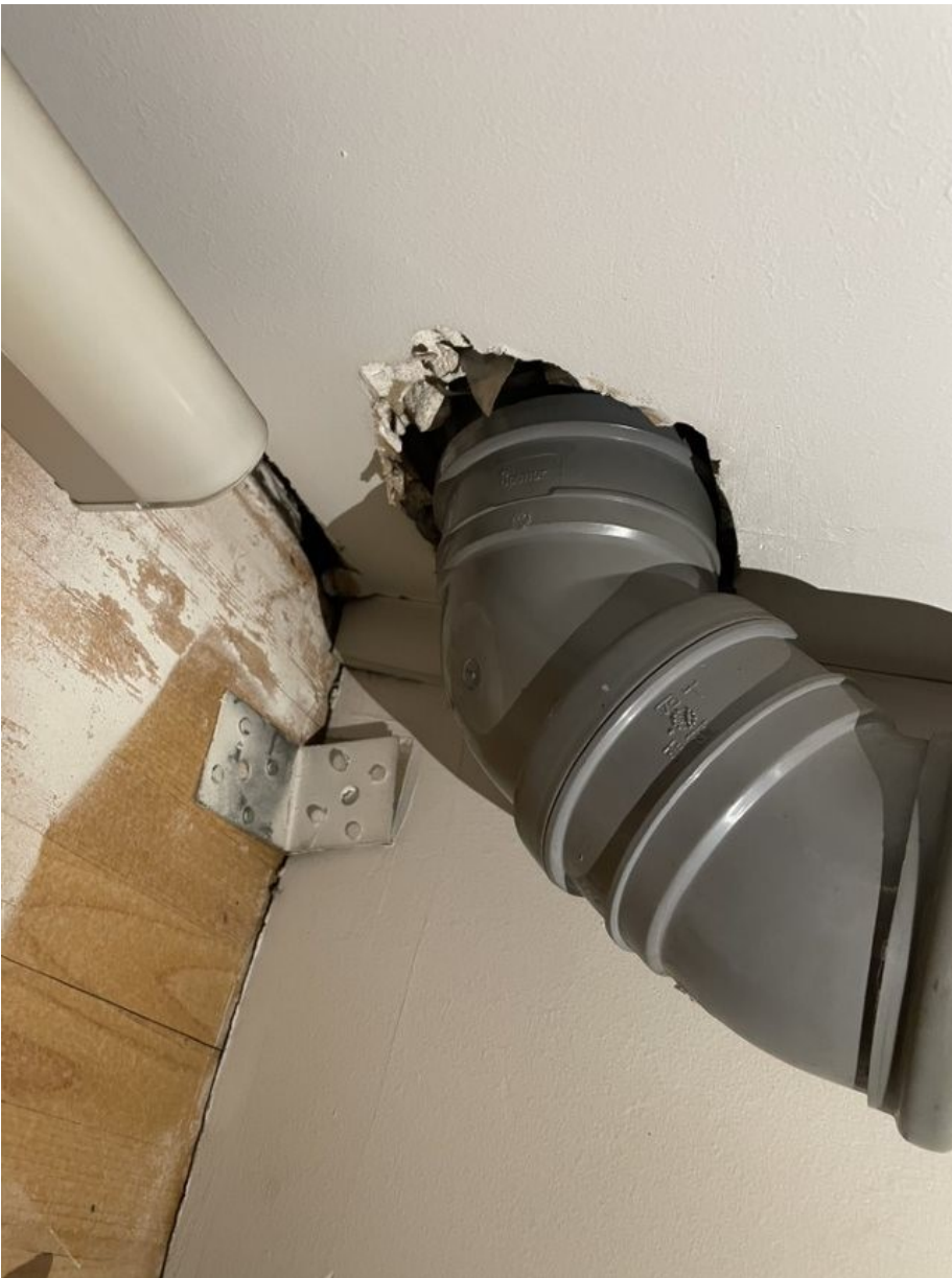
(Kuva 12. Epäsiististi tehty viemäriläpivienti)
