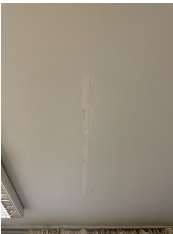
Kuva 23. Päivystystilan 05 katossa näkyvä vesivuodon korjauskohta.
