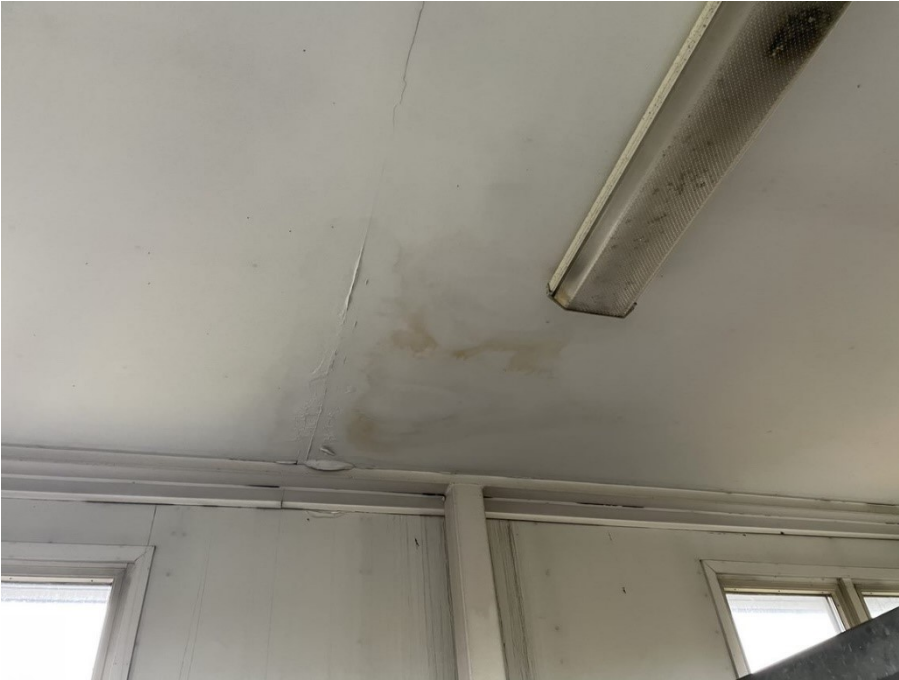
(Kuva 16. Letkunkuivaustornin katossa ollut vuoto)
