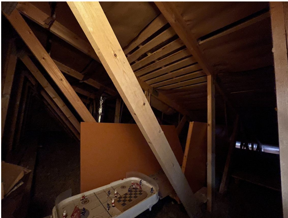
Kuva 17. Yläpohjatilaan varastoidut tavarat ja vesikattorakenteen irronneet aluskatepaperit
