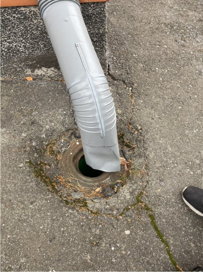
(Kuva 11. Kolhiintunut syöksytorvi)
