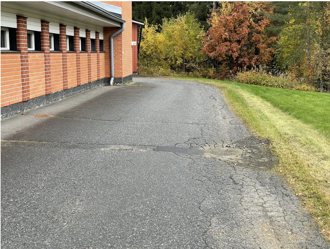
(Kuva 1. Pahoin routunut asfaltti)
