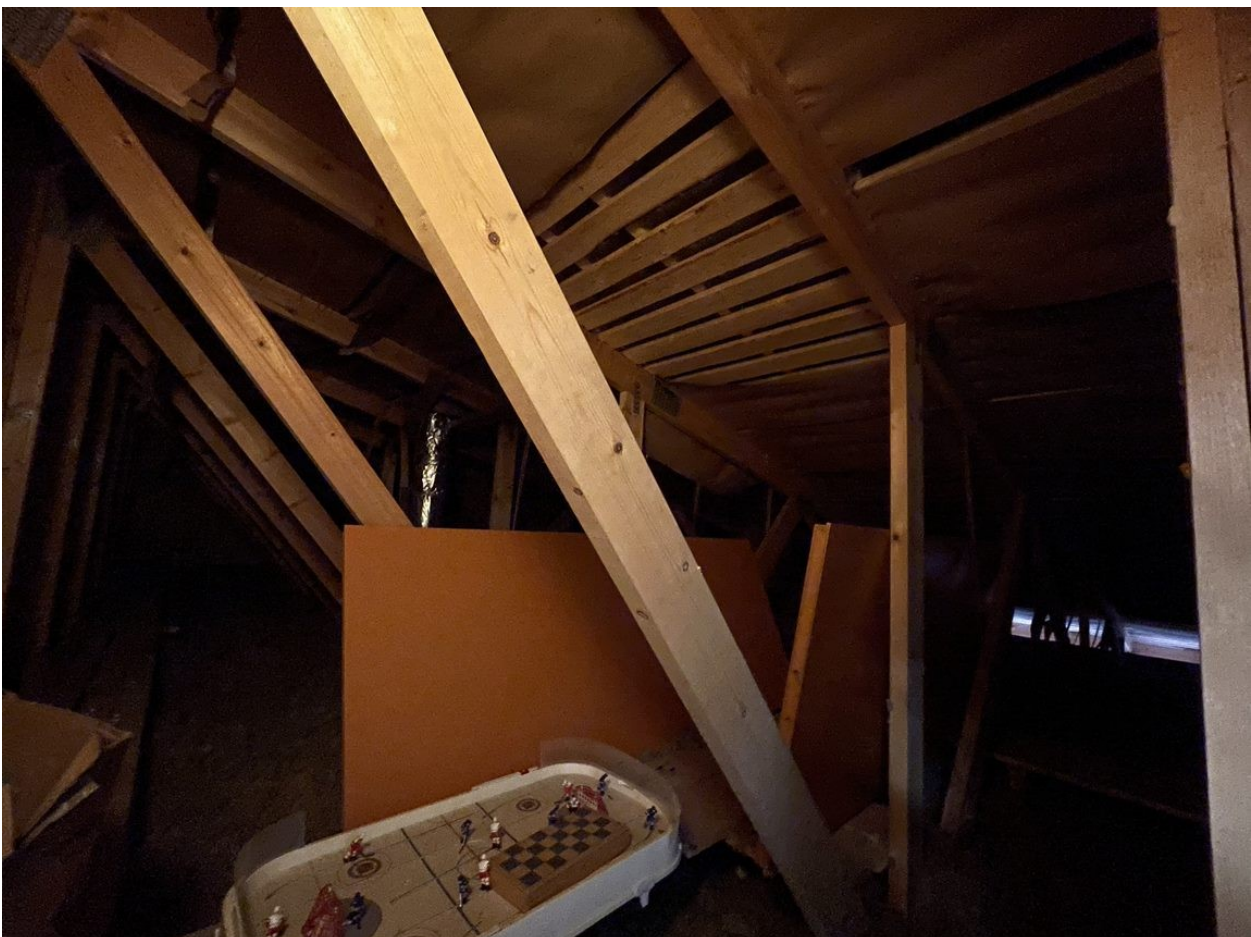
(Kuva 9. Kattorakenteen irronnut aluskatepaperi)
