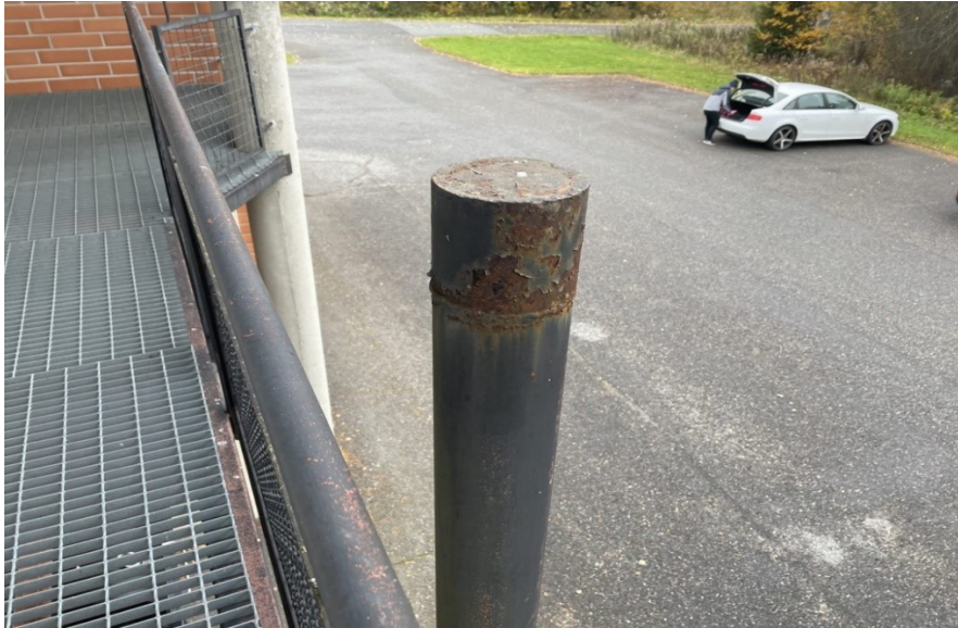
Kuva 11. Rakennuksen teräsparvekkeen ruostunut teräspilari
