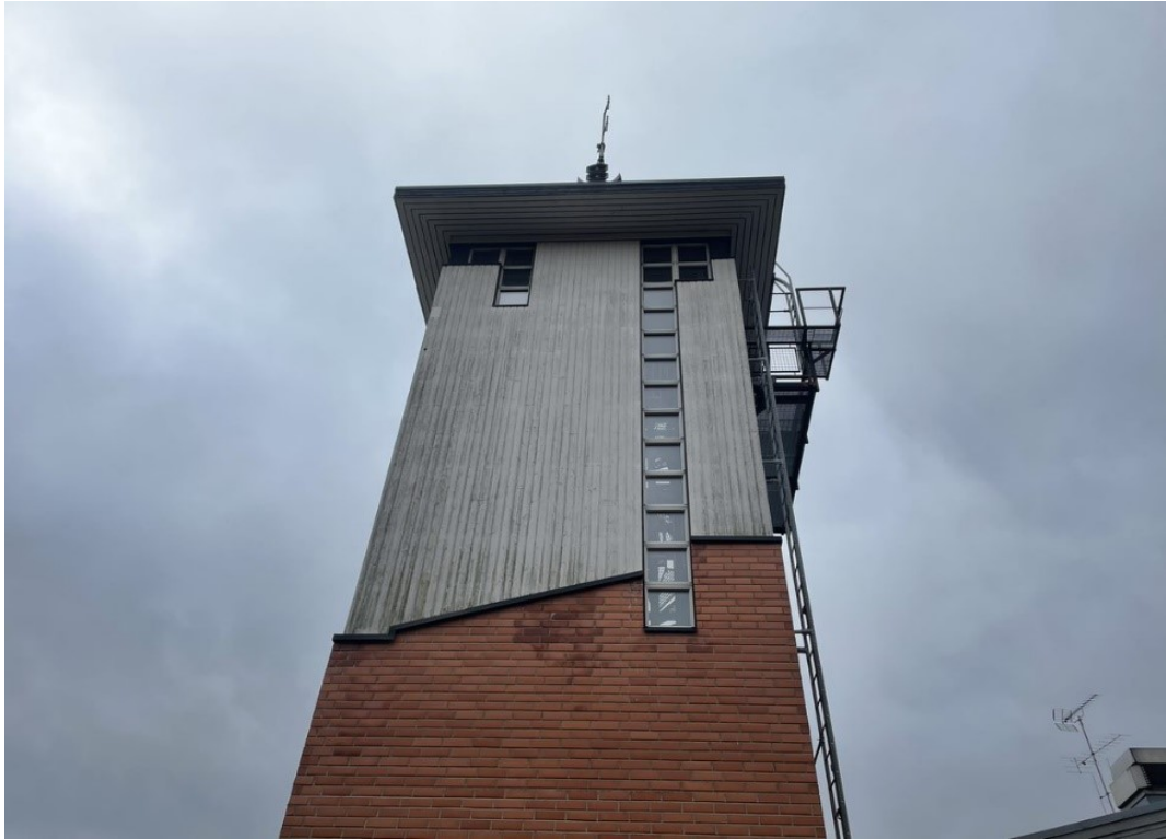
Kuva 15. Letkunkuivaustornin kärsinyt julkisivupanelointi
