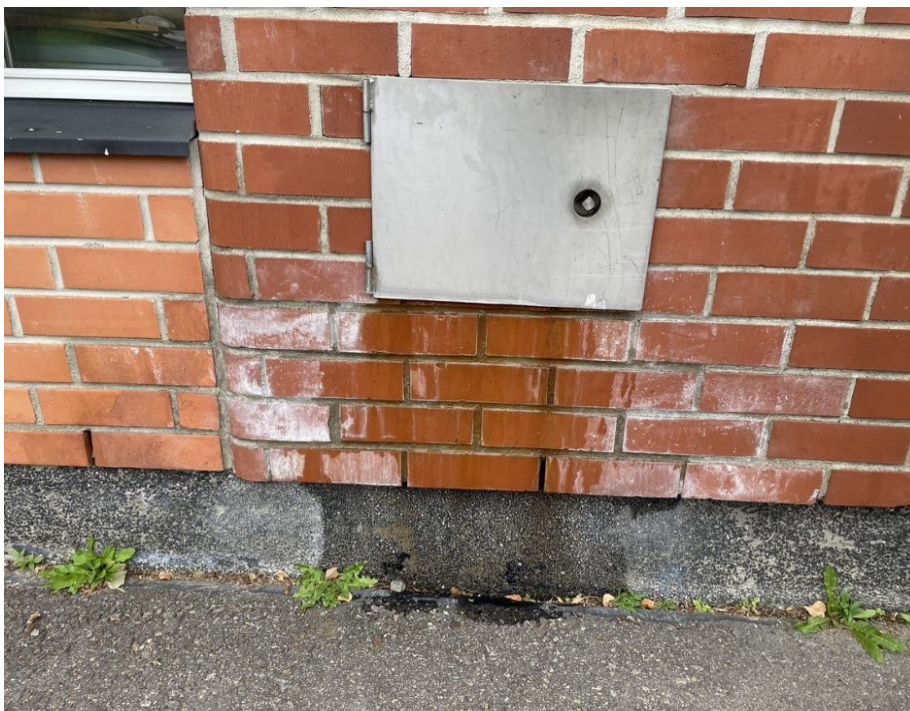
Kuva 13. Vuotaneen vesipisteen kastelemat tiilet
