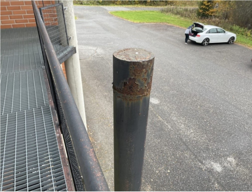
(Kuva 3. Ruostunut teräspilari)
