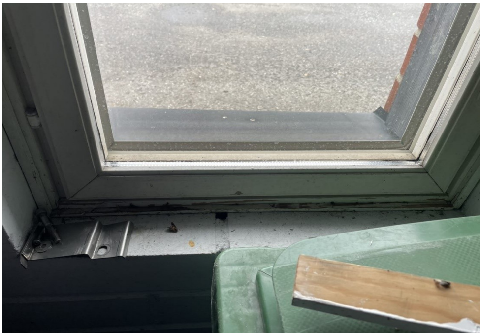
Kuva 16. Pesulinjaston viereisen seinän ikkuna, josta on hilseillyt maali
