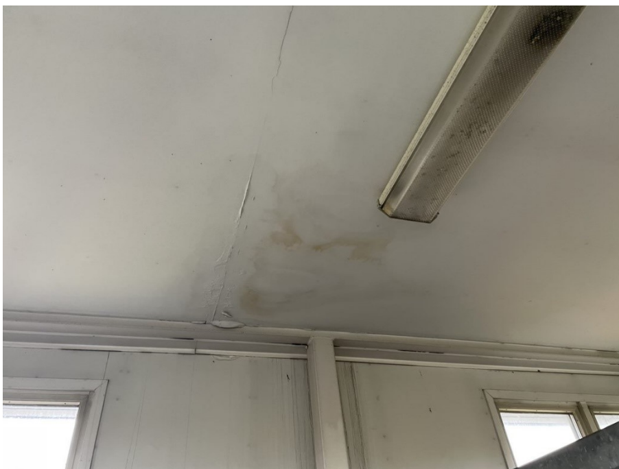
Kuva 22. Letkunkuivaustornin kattorakenteessa näkyvä tummentunut kohta
