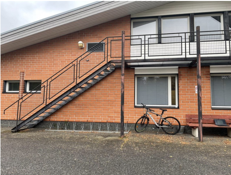
(Kuva 2. Rakennuksen ”luhtikäytävän” ruostuneet teräspilarit ja irronnut maali)
