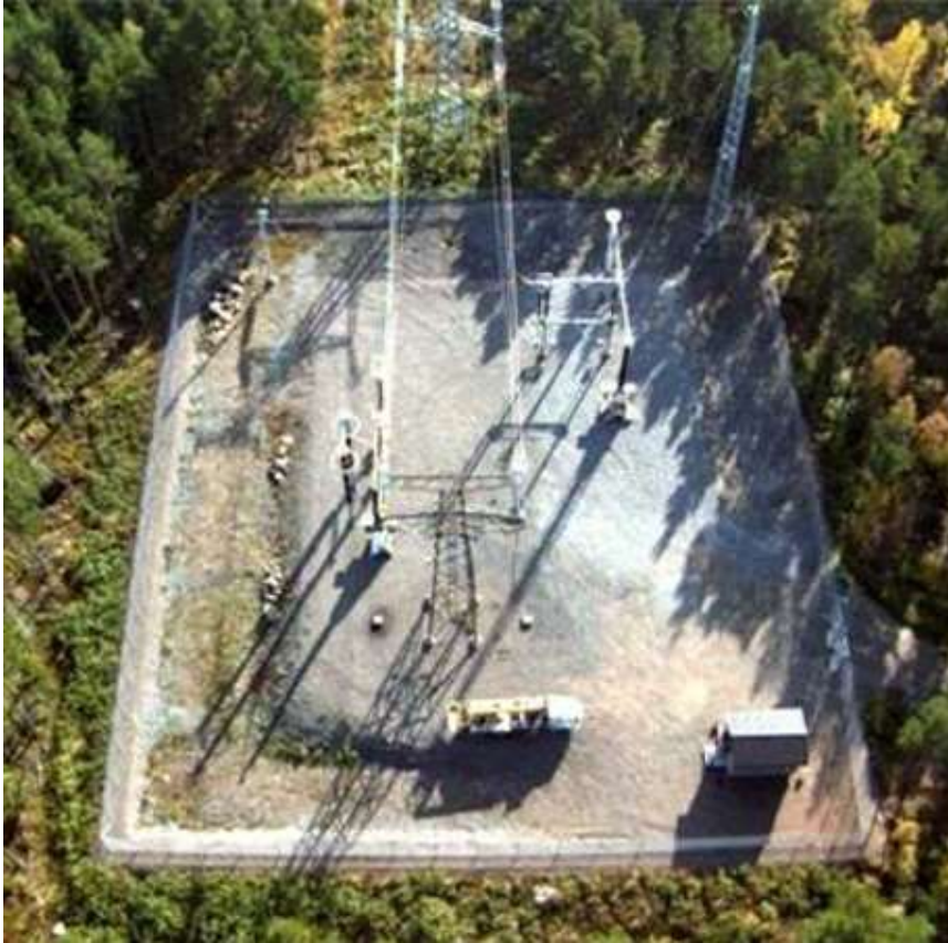
Kuva 3 Avojohtimien päätepylväs Rihtniemessä (Jalonen 2021)
