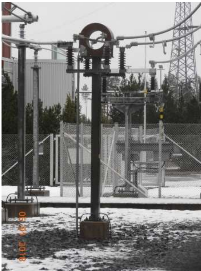
Kuva 7 Elektrodipiirin erovirtamuuntaja sähköasemalla (Nuotio 2018, 21)
