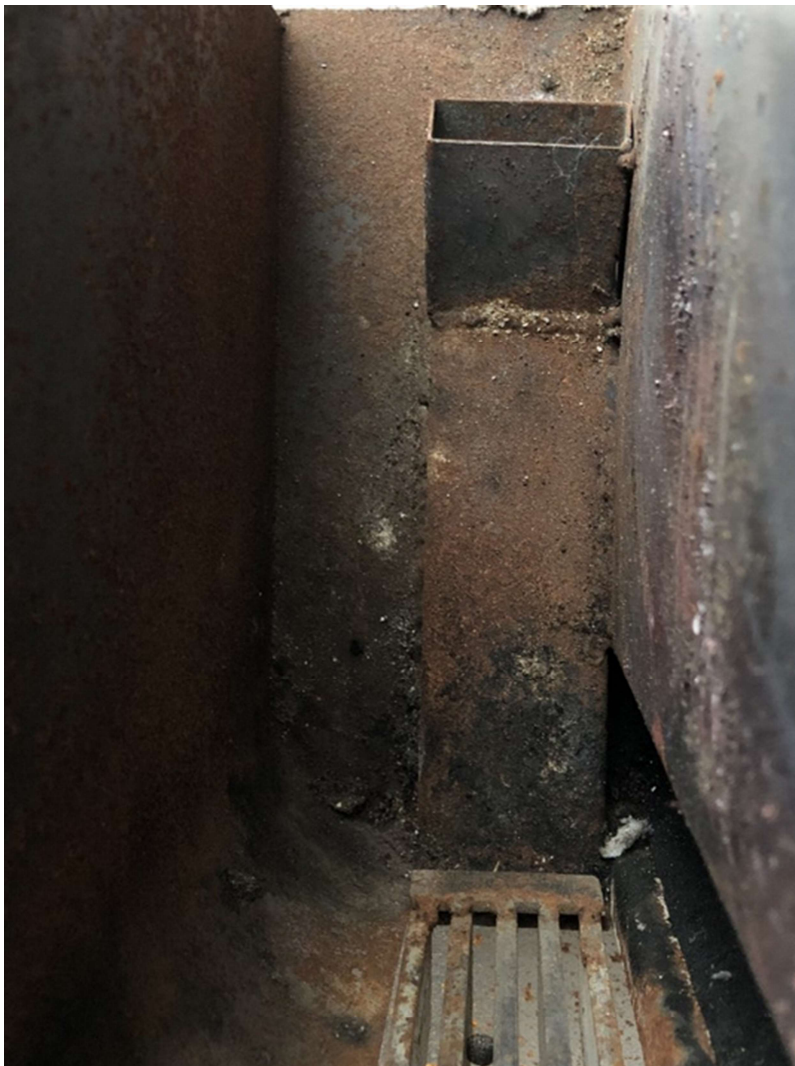
Kuva 11. Sekundääri-ilmaputki (Kuva: Olli-Matti Heiskanen).
