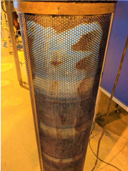
KUVA 31. Tukkeutunut ja osittain korkeapainepesty painesuodattimen verkko
