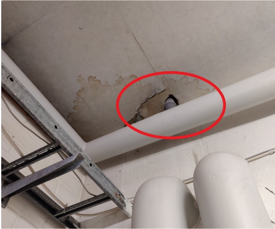
Kuva 3. Lämmönjakohuoneen viemäriputken läpiviennin vuotokohta.
