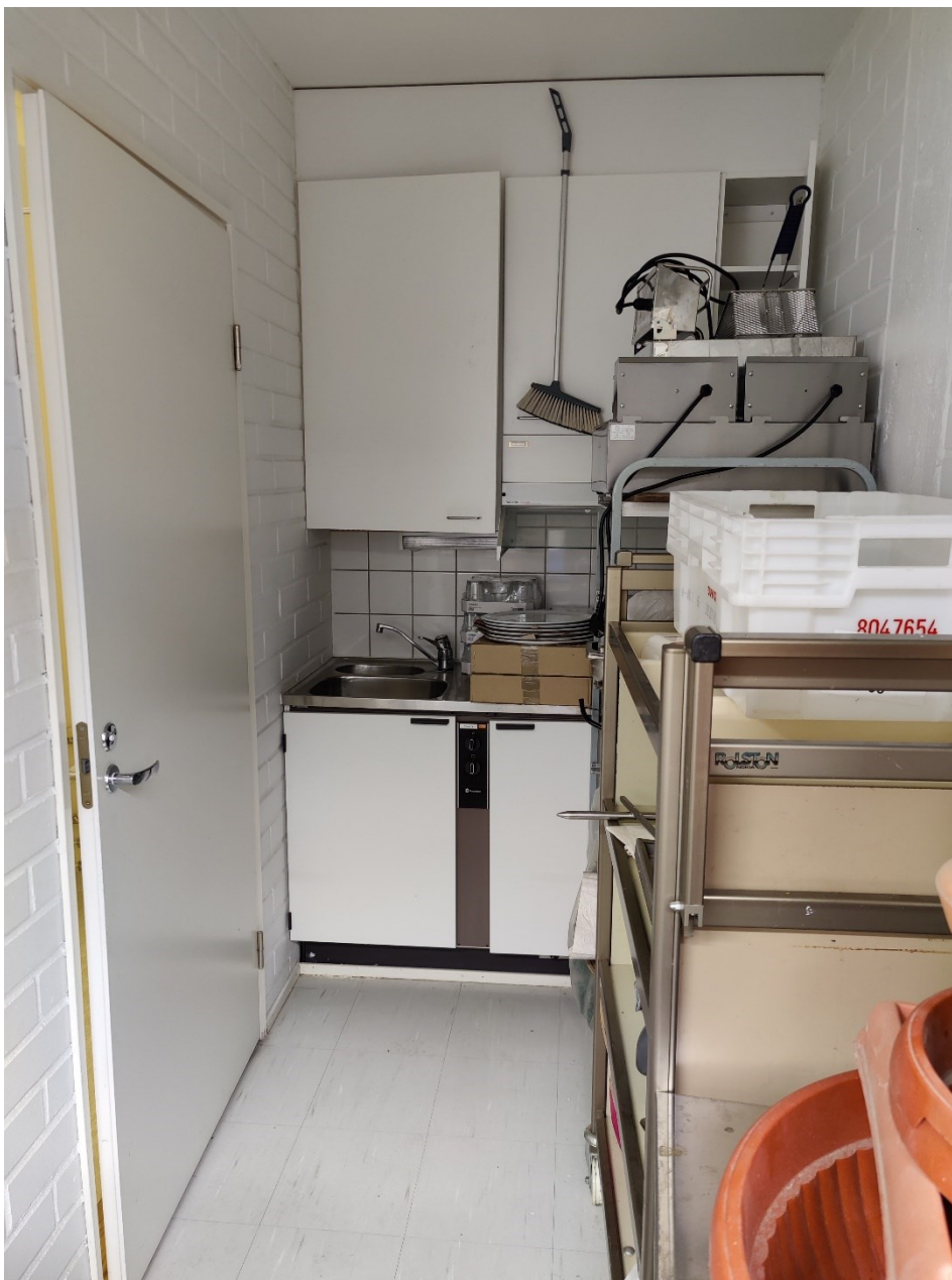
Kuva 6. Kellarikerroksen keittiö, jossa havaittiin viemäristä tulevaa poikkeavaa hajua.
