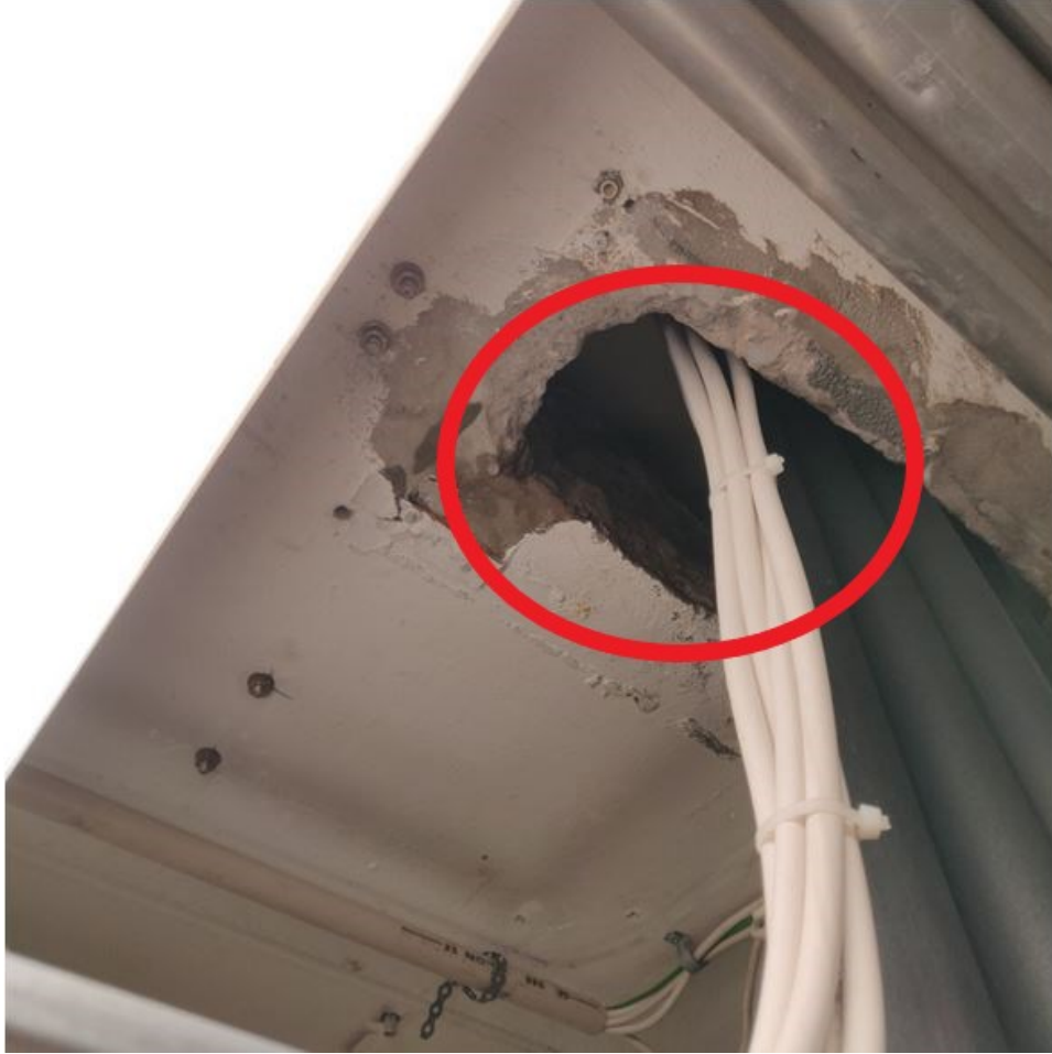
Kuva 9. Kompressorikonehuoneen sähköjohtojen läpiviennin vuotokohta
