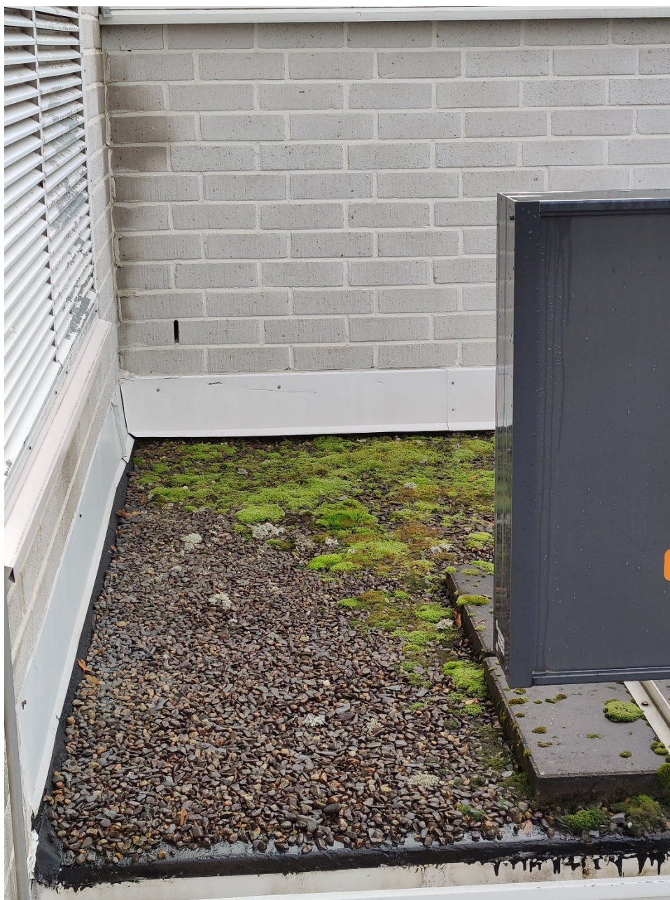
Kuva 12. Vesikaton karkearakeinen sora ja sammalkasvustoa.
