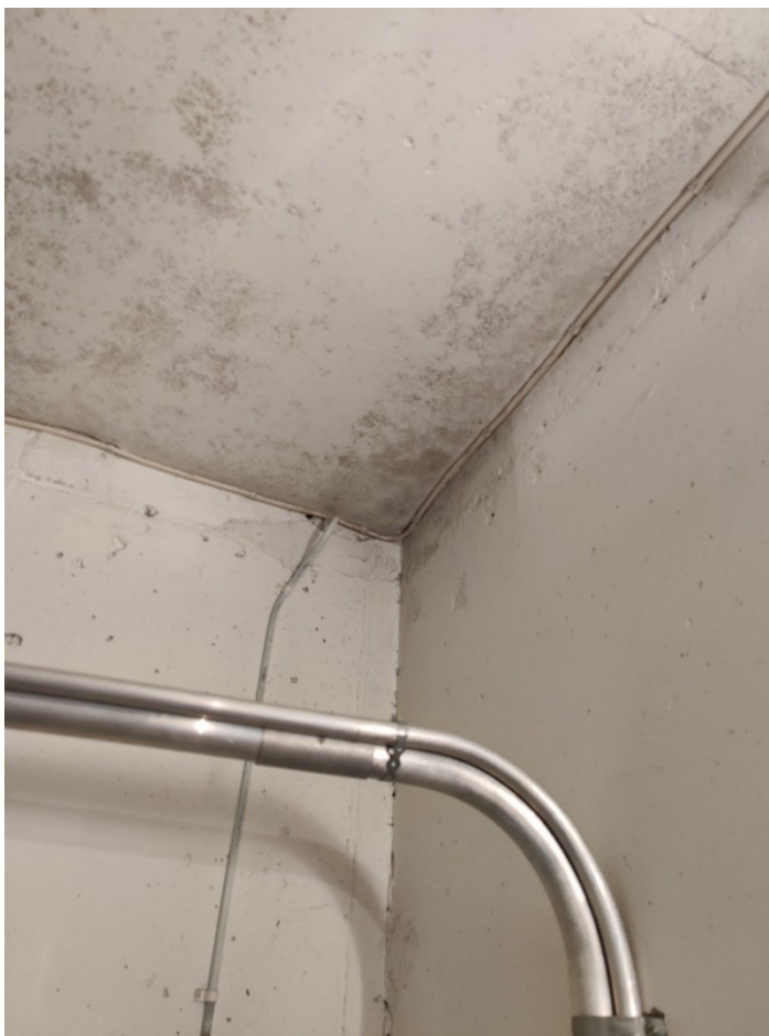
Kuva 17. Kameralla otettu kuva lämpövuotosaumasta.
