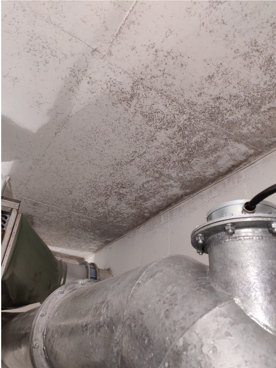
Kuva 9. Mikrobikasvustoa kellarikerroksen IV-konehuoneen katossa.
