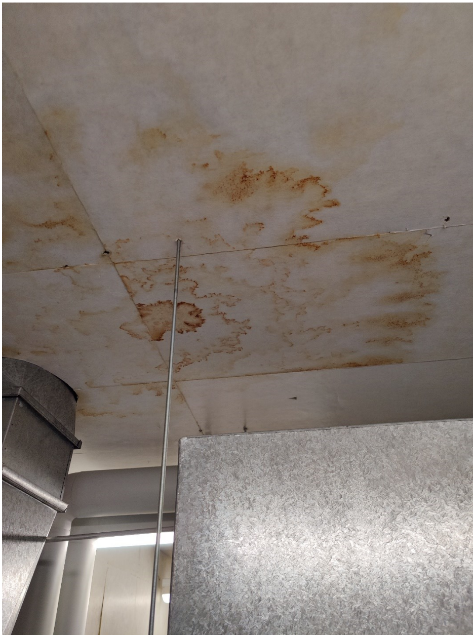
Kuva 11. Kattokerroksen IV-konehuoneen katossa havaittiin kosteutta.
