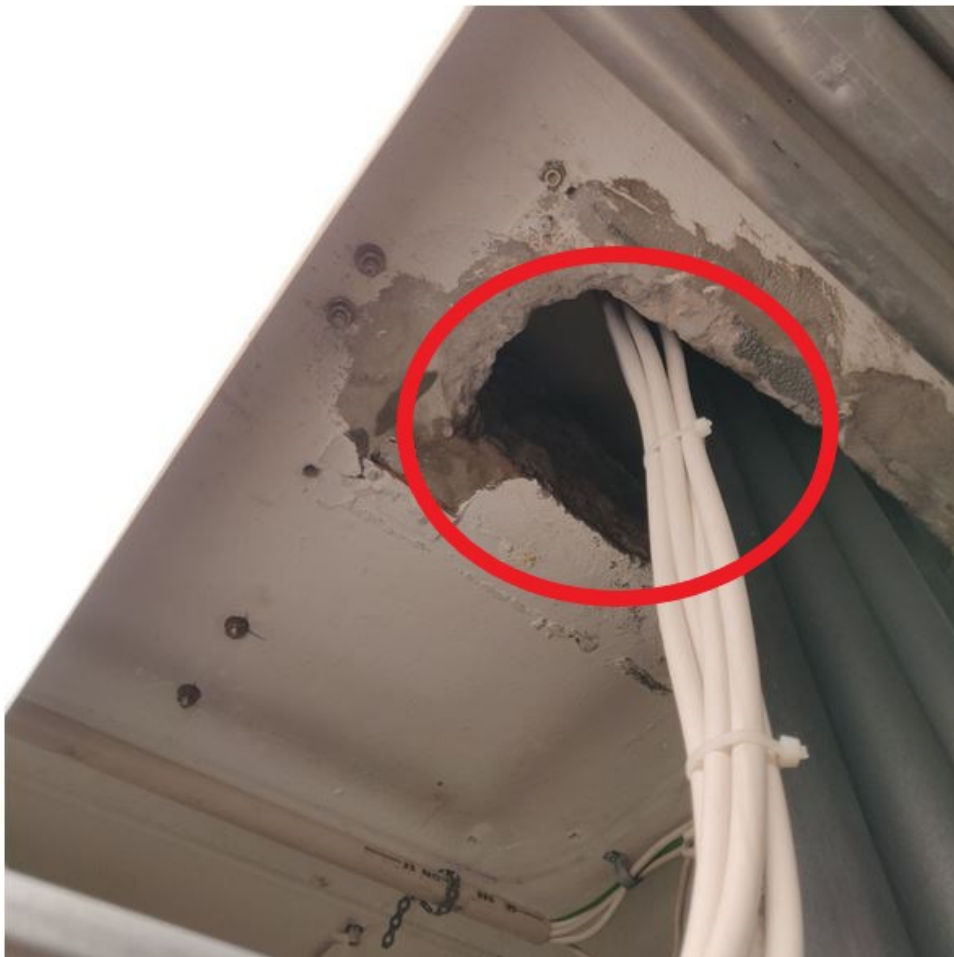
Kuva 10. Kompressorikonehuoneen sähköjohtojen läpiviennin vuotokohta
