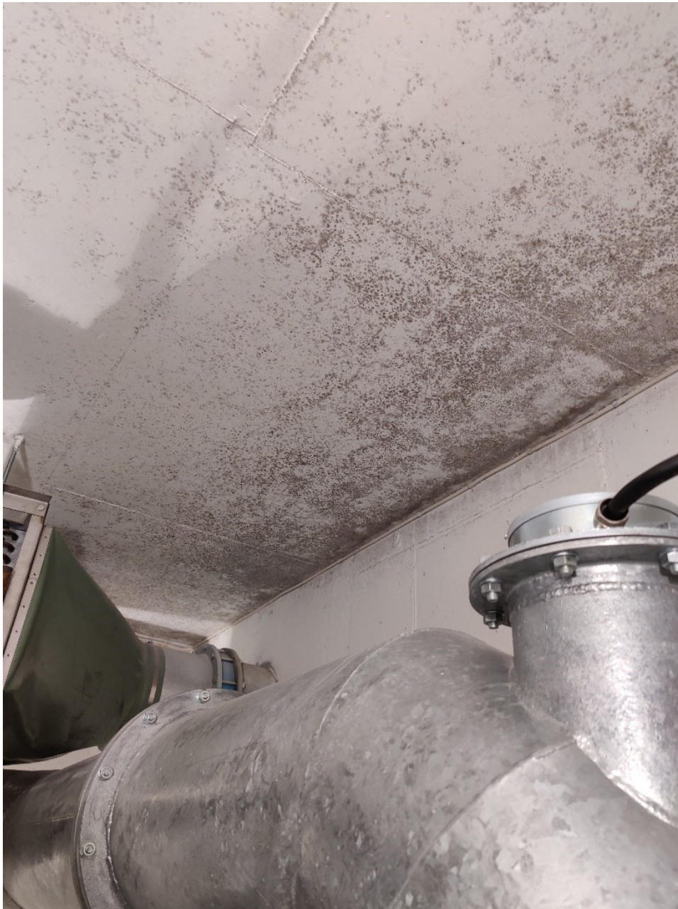
Kuva 19. Mikrobikasvustoa kellarikerroksen IV-konehuoneen katossa.
