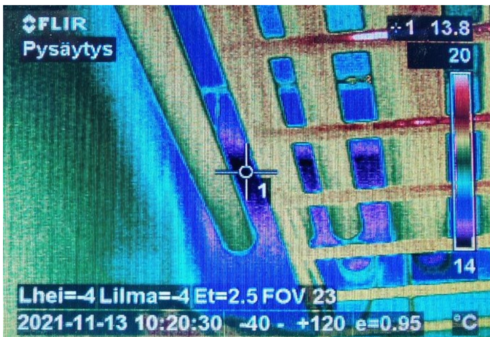
Kuva 13. Lämpövuotoa kiinteistövaraston saumassa.
