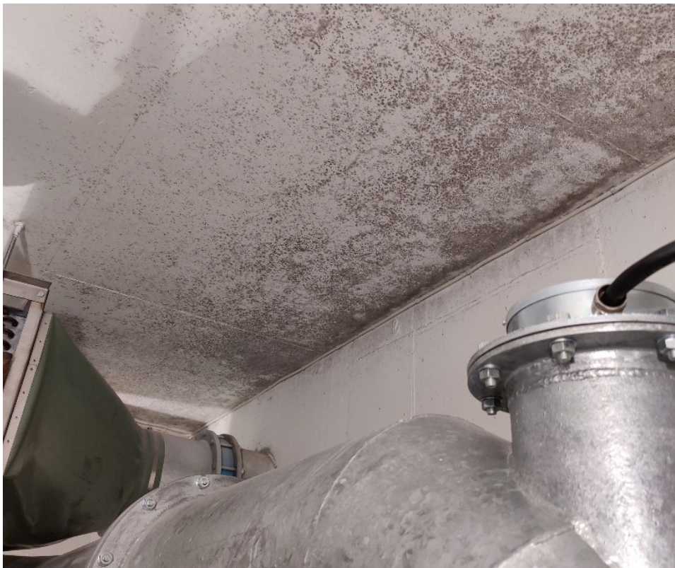
Kuva 8. Mikrobikasvustoa kellarikerroksen IV-konehuoneen katossa.
