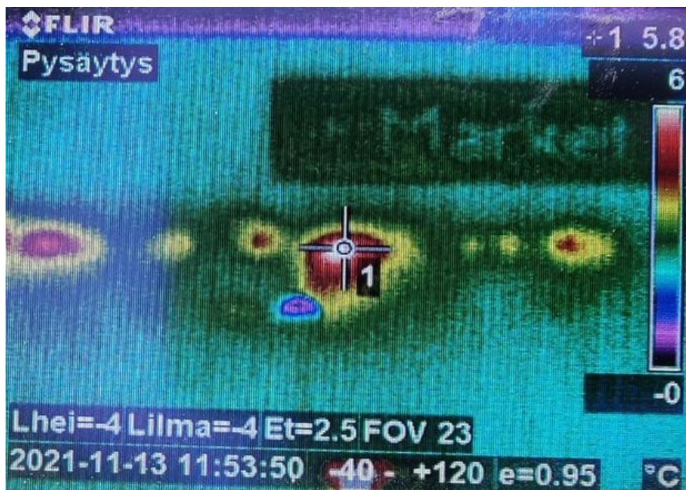
Kuva 27. Lämpövuotoa rakennuksen itäpäädyssä.
