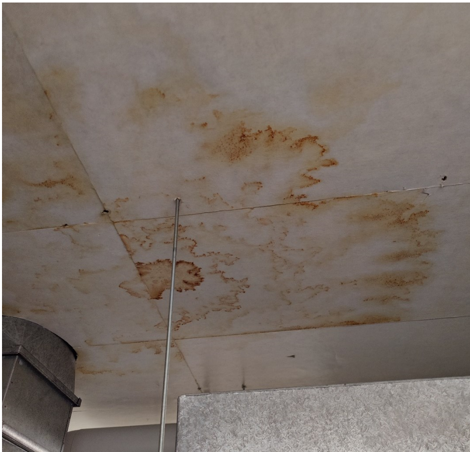
Kuva 10. Kattokerroksen IV-konehuoneen katossa havaittiin kosteutta.
