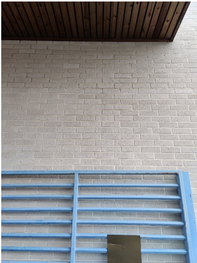
Kuva 25. Kameralla otettu kuva lämpövuotokohdasta.
