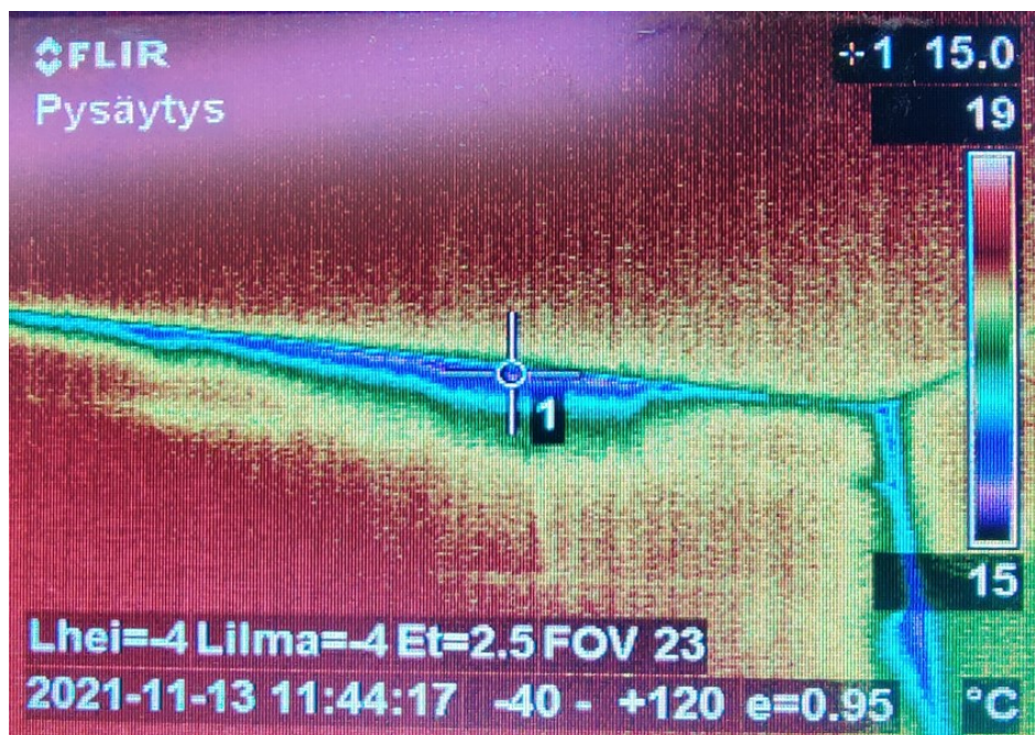
Kuva 30. Lämpövuotoa IV-konehuoneen saumakohdissa.
