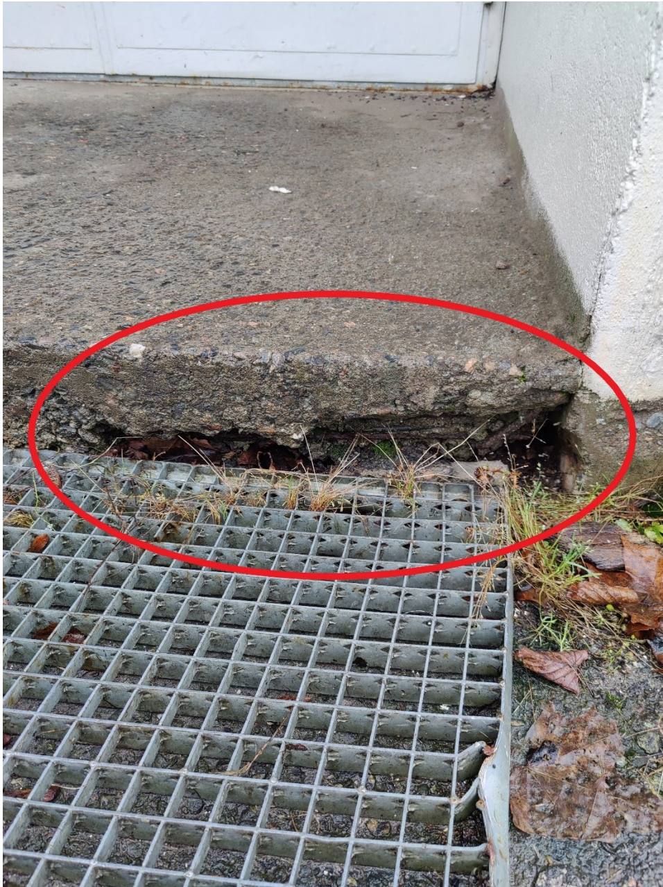
Kuva 7. Betonilaatan nurkan lohkeama.
