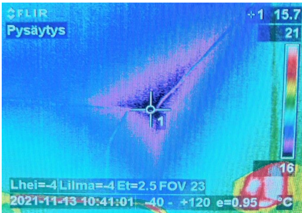
Kuva 15. Lämpövuoto saumassa kiinteistövaraston seinän pohjoispäädyssä.
