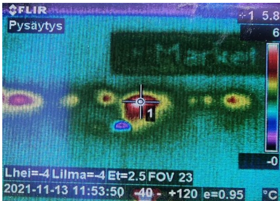
Kuva 26. Lämpövuotoa rakennuksen itäpäädyssä.
