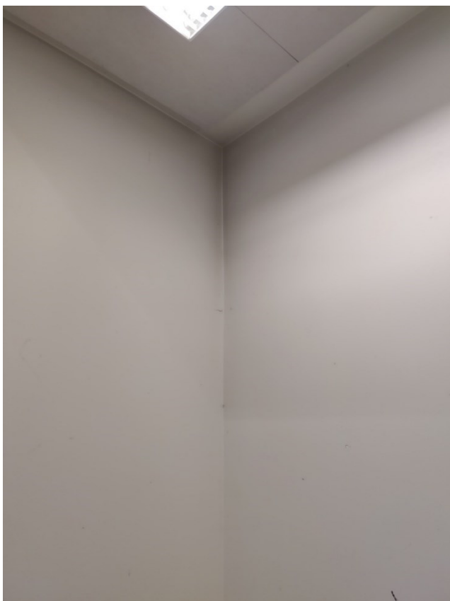
Kuva 23. Kameralla otettu kuva lämpövuodon kohdasta.
