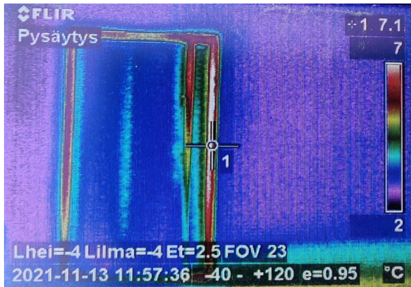
Kuva 29. Lämpövuotoa rakennuksen oven ja karmin välisissä eristeissä.
