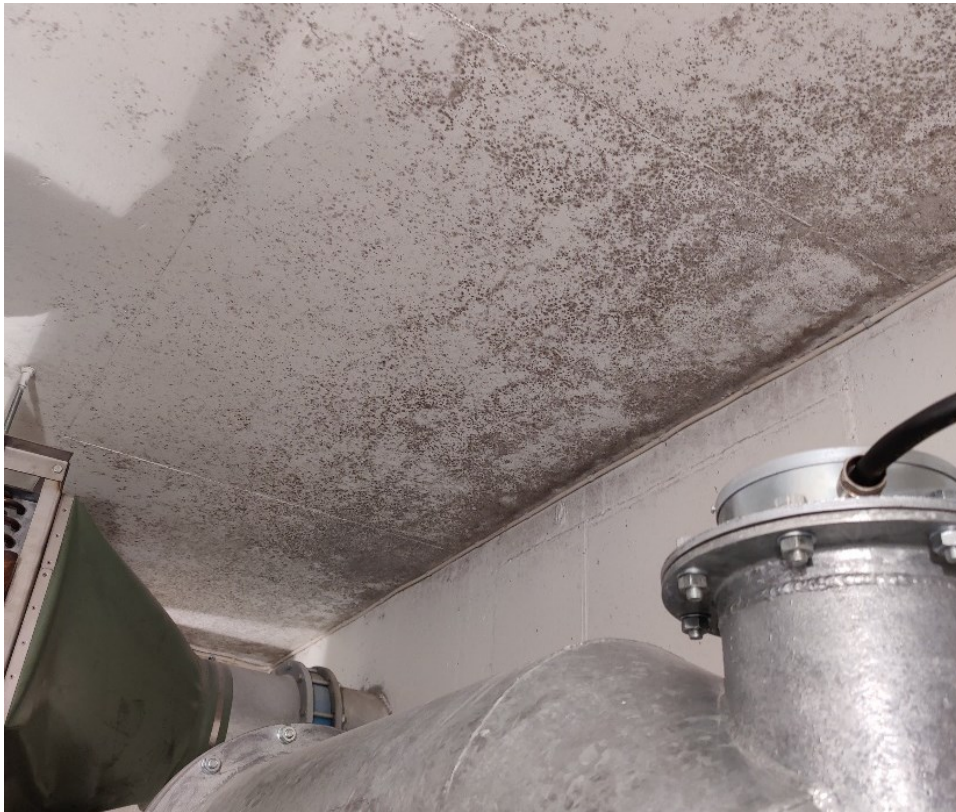
Kuva 18. Mikrobikasvustoa kellarikerroksen IV-konehuoneen katossa.
