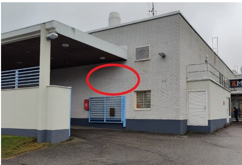
Kuva 24. Kameralla otettu kuva lämpövuotokohdasta.
