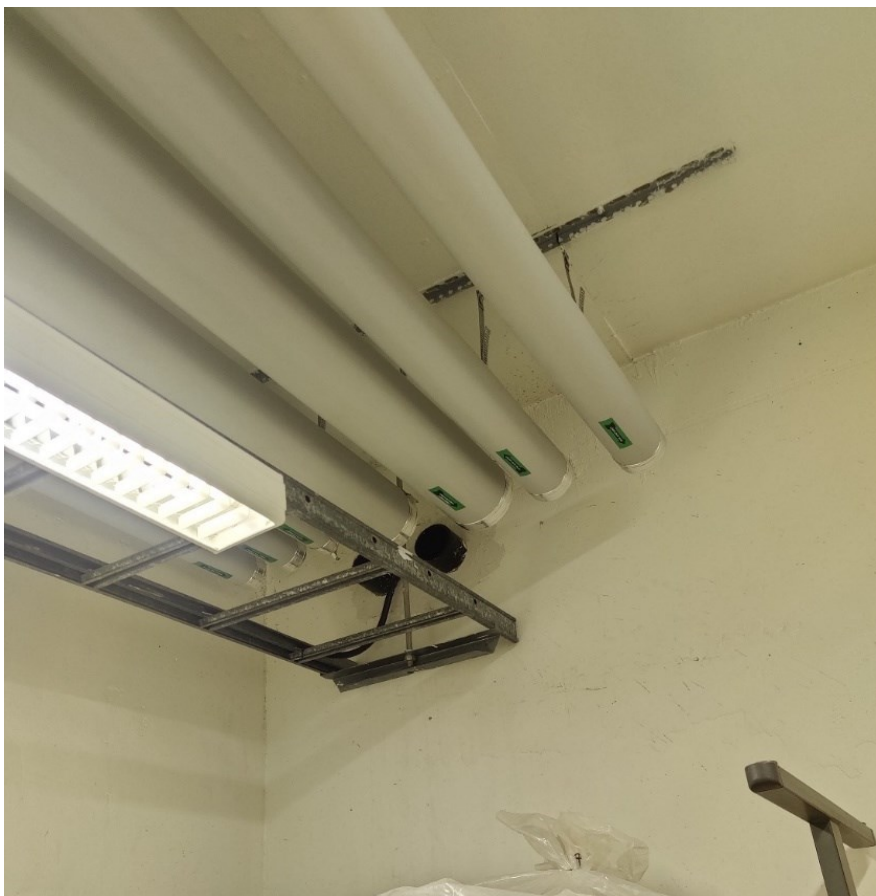
Kuva 13. Kameralla otettu kuva lämpövuotosaumasta.
