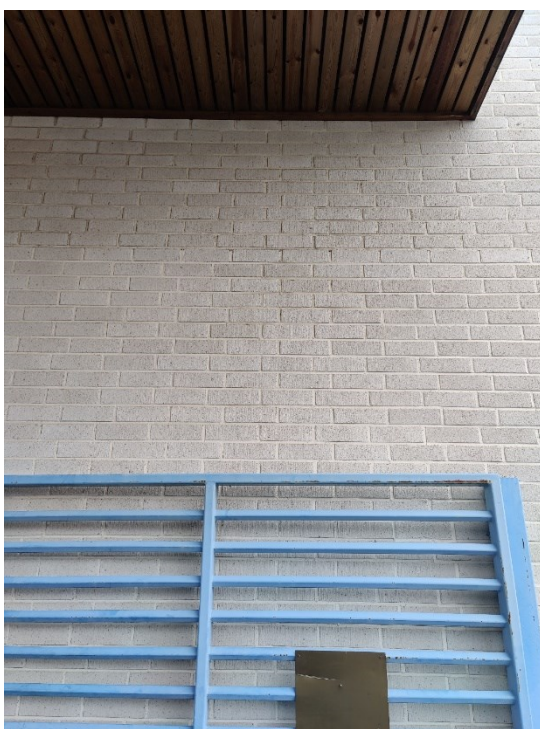
Kuva 26. Kameralla otettu kuva lämpövuotokohdasta.
