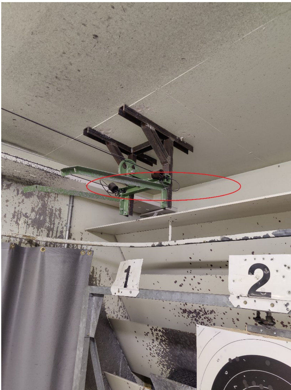
Kuva 21. Kameralla otettu kuva lämpövuodosta kellarin ampumaradan eteläpäädyn saumassa.
