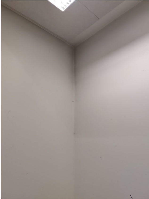
Kuva 22. Kameralla otettu kuva lämpövuodon kohdasta.
