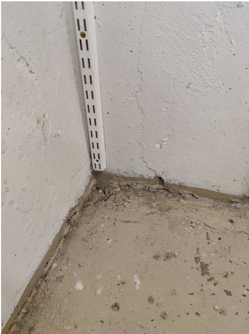
Kuva 5. Lämmönjakuhuoneen lattialaatan mahdollinen painuma.
