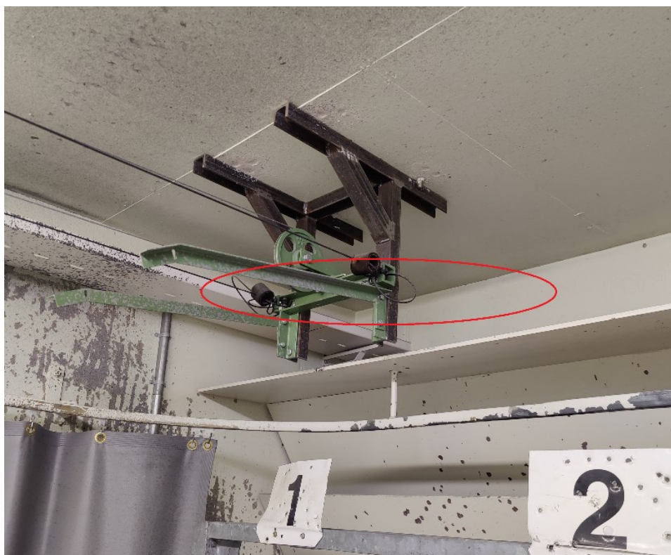
Kuva 20. Kameralla otettu kuva lämpövuodosta kellarin ampumaradan eteläpään saumassa.
