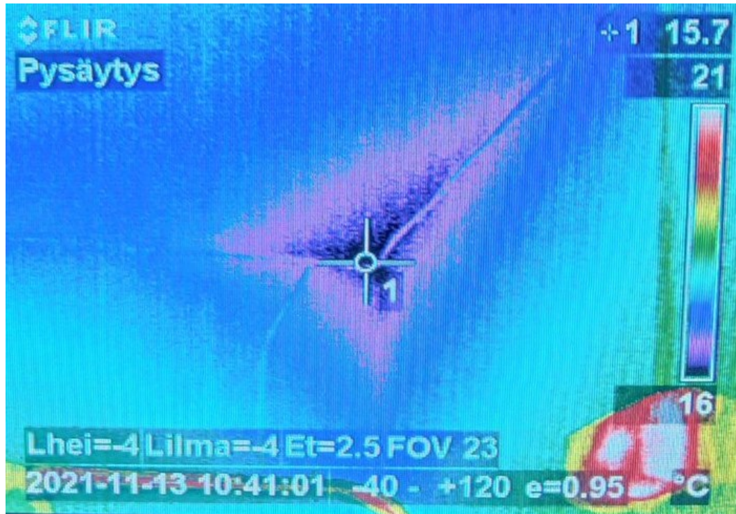
Kuva 14. Lämpövuoto saumassa kiinteistövaraston seinän pohjoispäädyssä.
