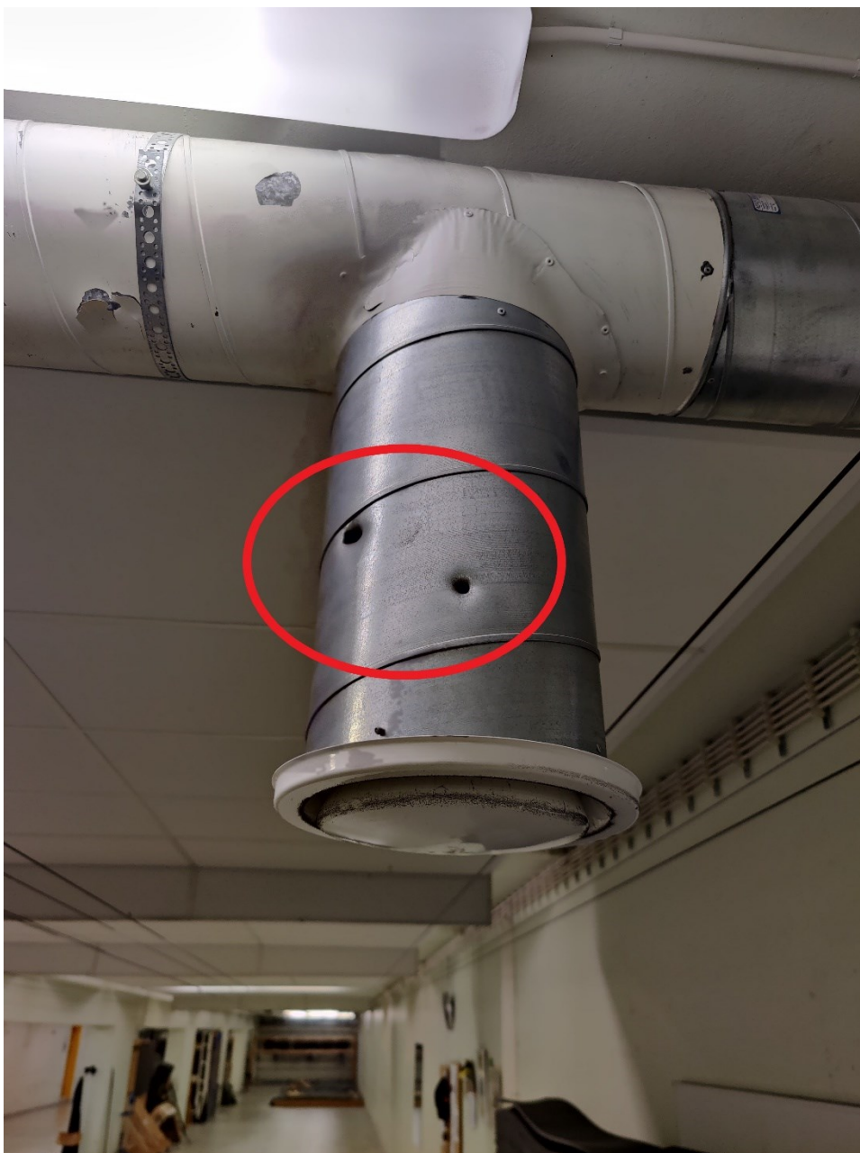
Kuva 8. Luodin aiheuttamia reikiä poistoilmaventtiilissä.
