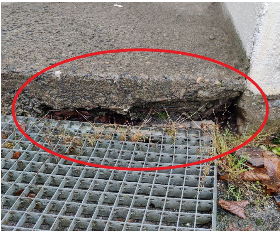
Kuva 6. Betonilaatan nurkan lohkeama.
