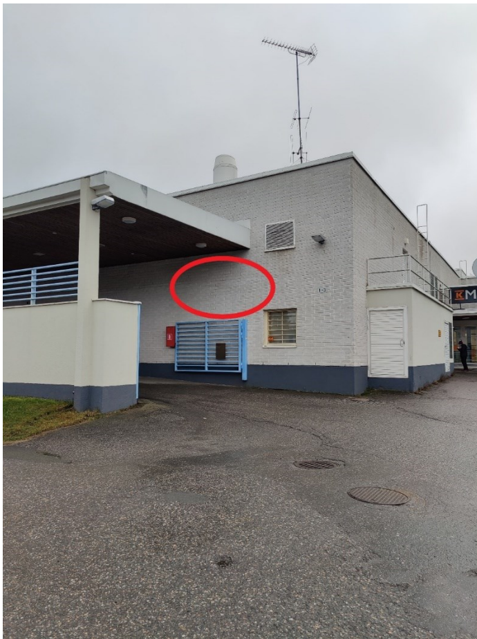
Kuva 25. Kameralla otettu kuva lämpövuotokohdasta.
