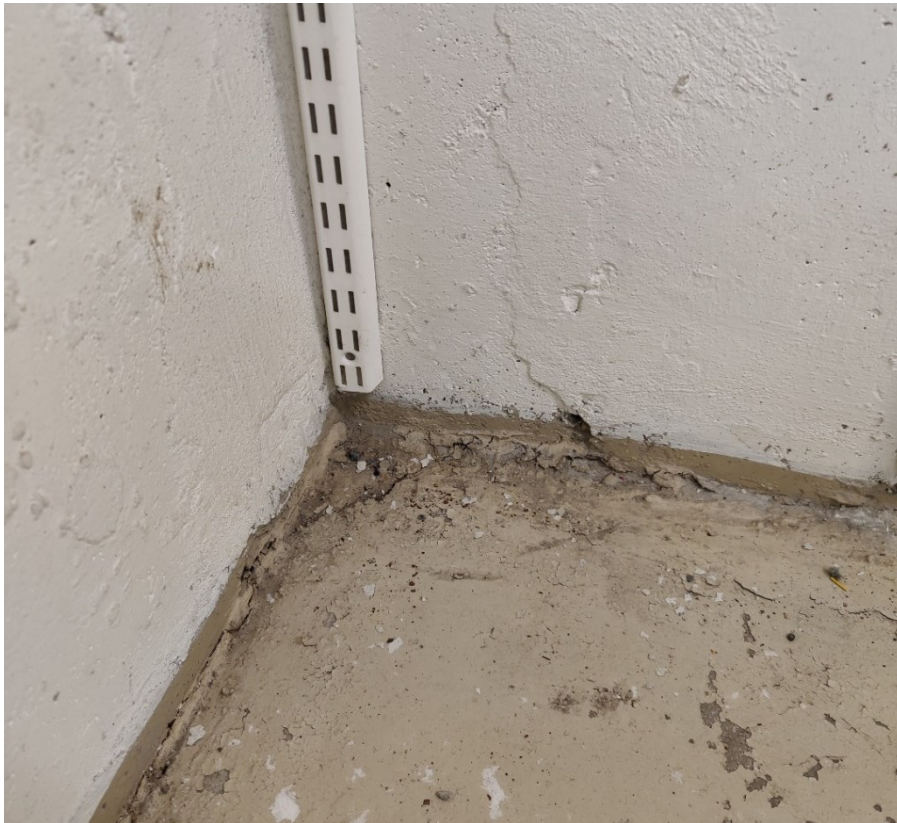
Kuva 4. Lämmönjakohuoneen lattialaatan mahdollinen painuma.
