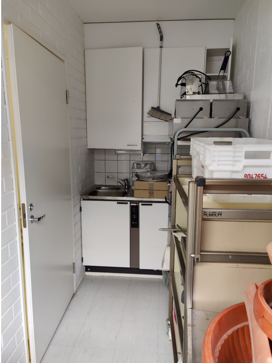
Kuva 5. Kellarikerroksen keittiö, jossa havaittiin viemäristä tulevaa poikkeavaa hajua.
