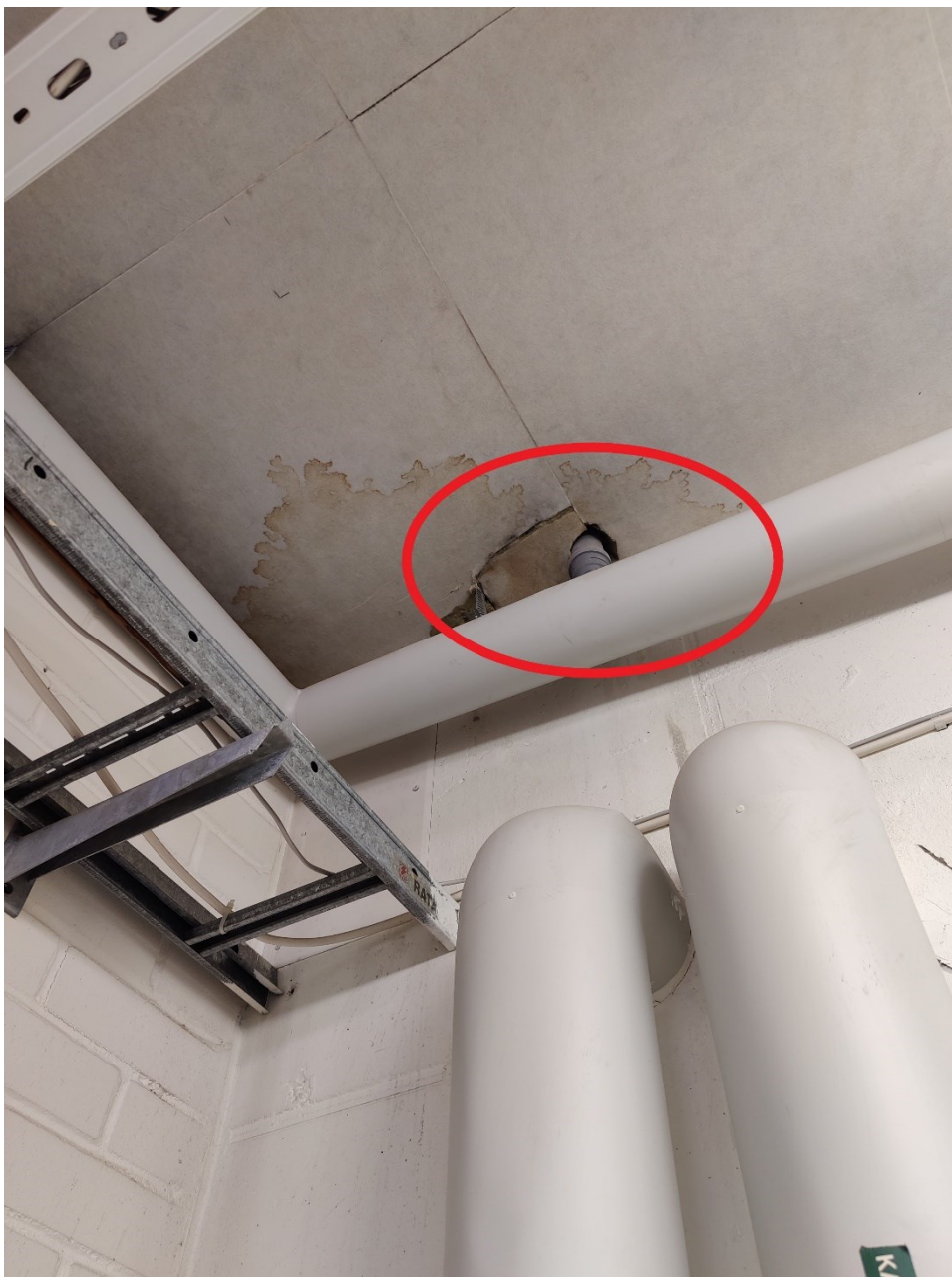
Kuva 4. Lämmönjakohuoneen viemäriputken läpiviennin vuotokohta.
