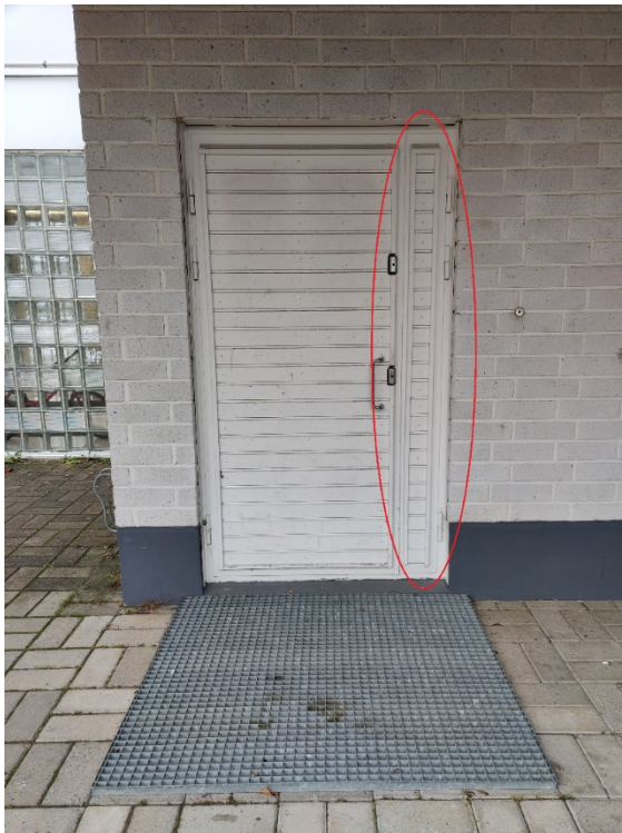
Kuva 30. Kameralla otettu kuva ovesta, jonka eristeissä havaittiin lämpövuotoa.
