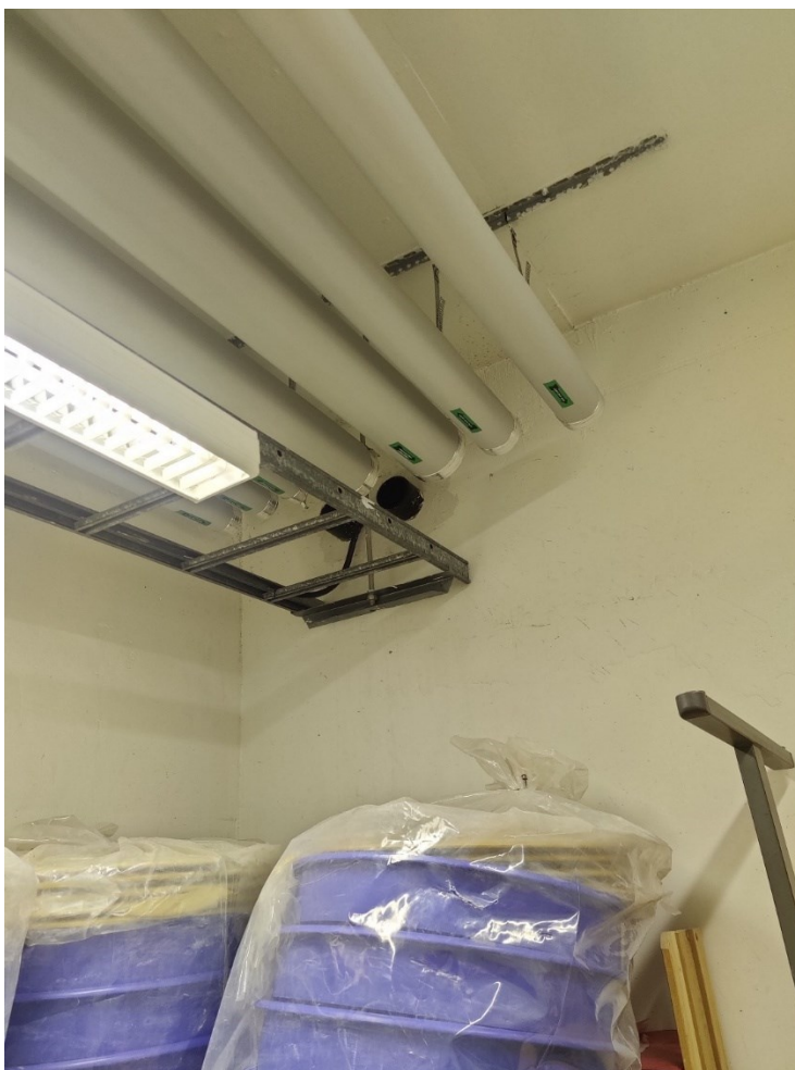
Kuva 14. Kameralla otettu kuva lämpövuotosaumasta.
