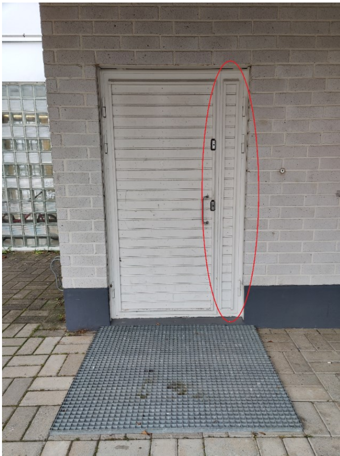
Kuva 29. Kameralla otettu kuva ovesta, jonka eristeissä havaittiin lämpövuotoa.
