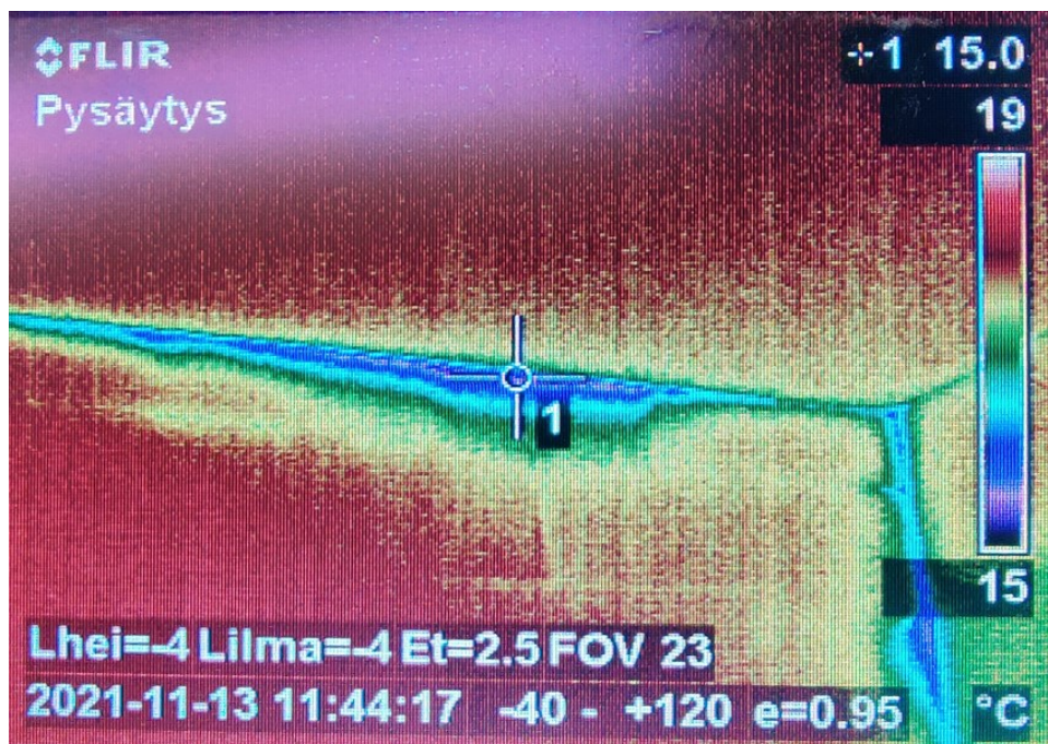
Kuva 31. Lämpövuotoa IV-konehuoneen saumakohdissa.
