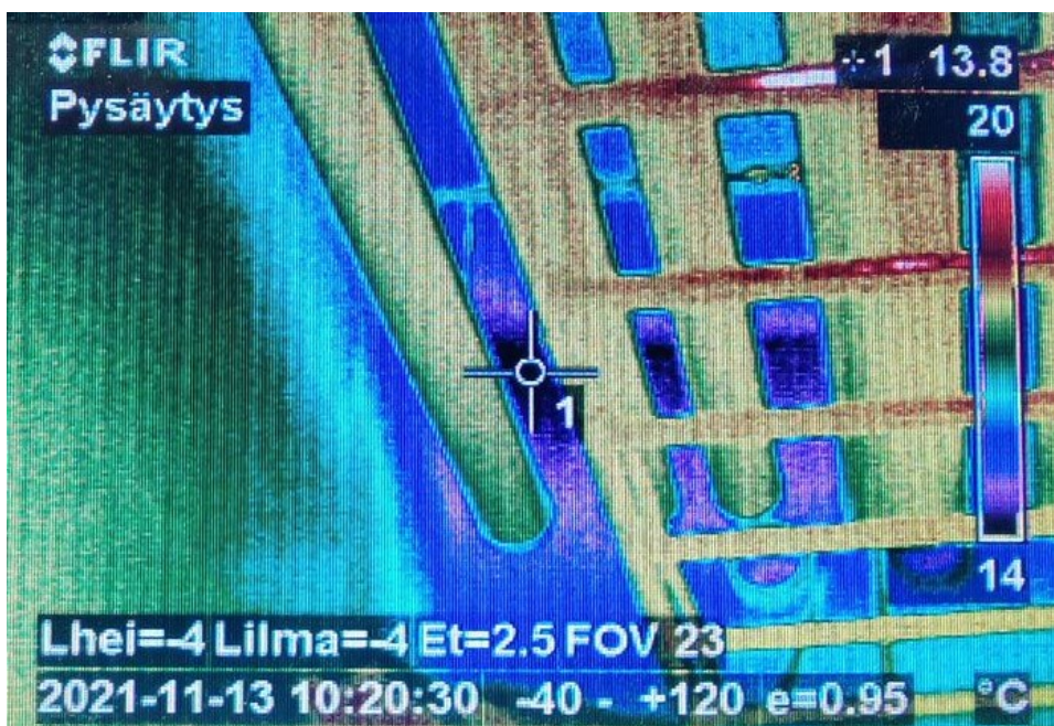
Kuva 12. Lämpövuotoa kiinteistövaraston saumassa.
