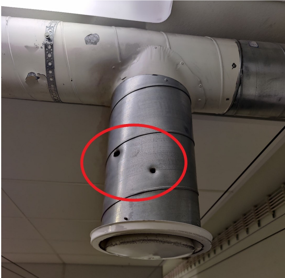
Kuva 7. Luodin aiheuttamia reikiä poistoilmaventtiilissä.
