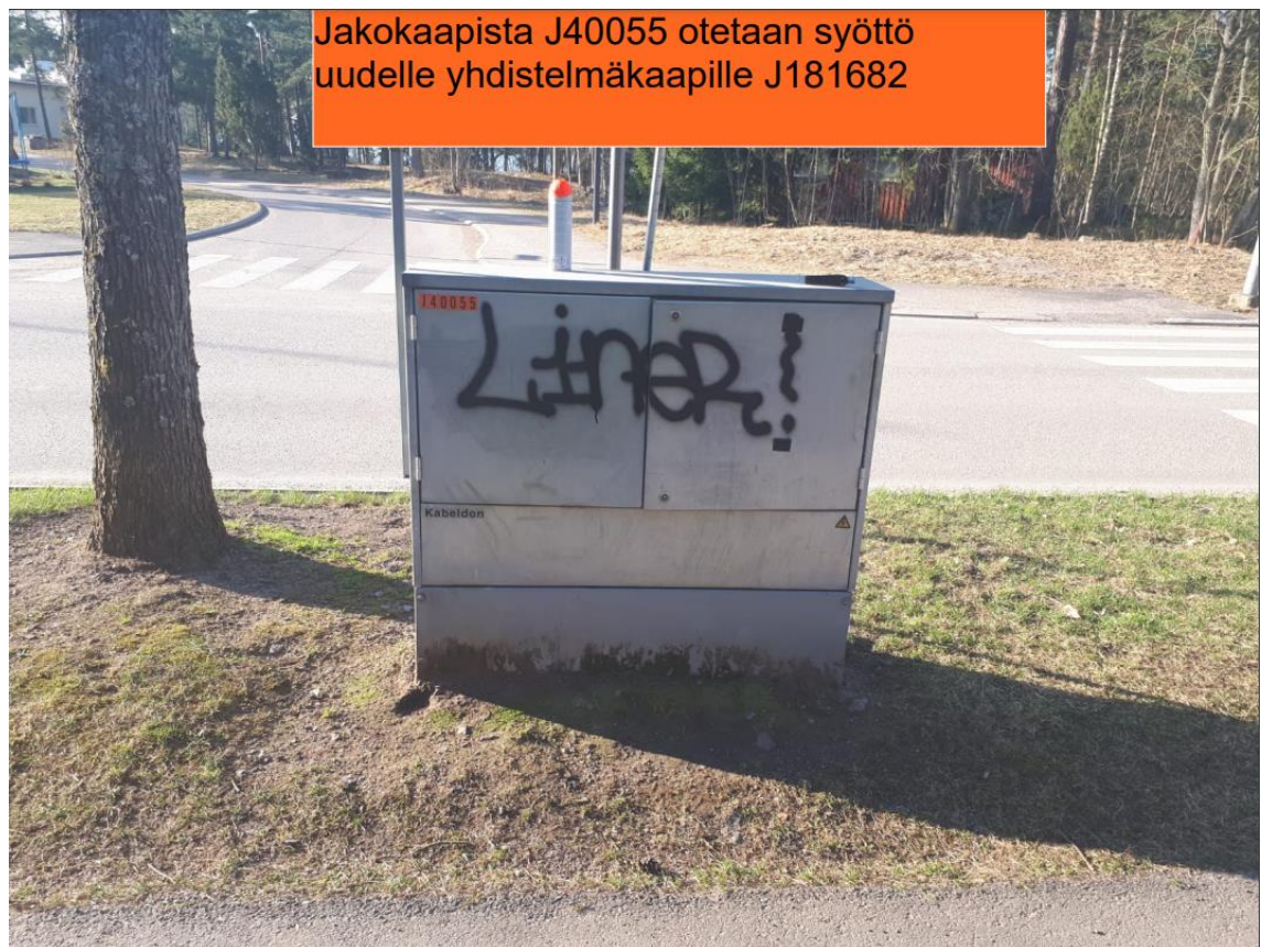
Kuva 4. Jännitteinen jakokaappi, josta otetaan sähkönsyöttö uudelle rakennettavalle Carunan yhdistelmäkaapille.
