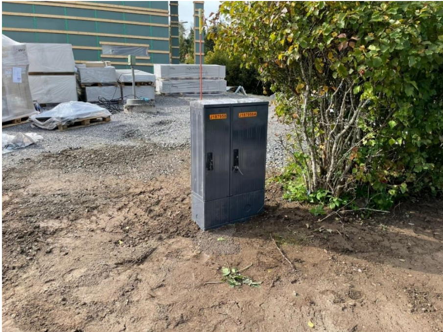
Kuva 1. Asiakkaan uusi sähköliittymä toteutettuna yhdistelmäkaapilla.
