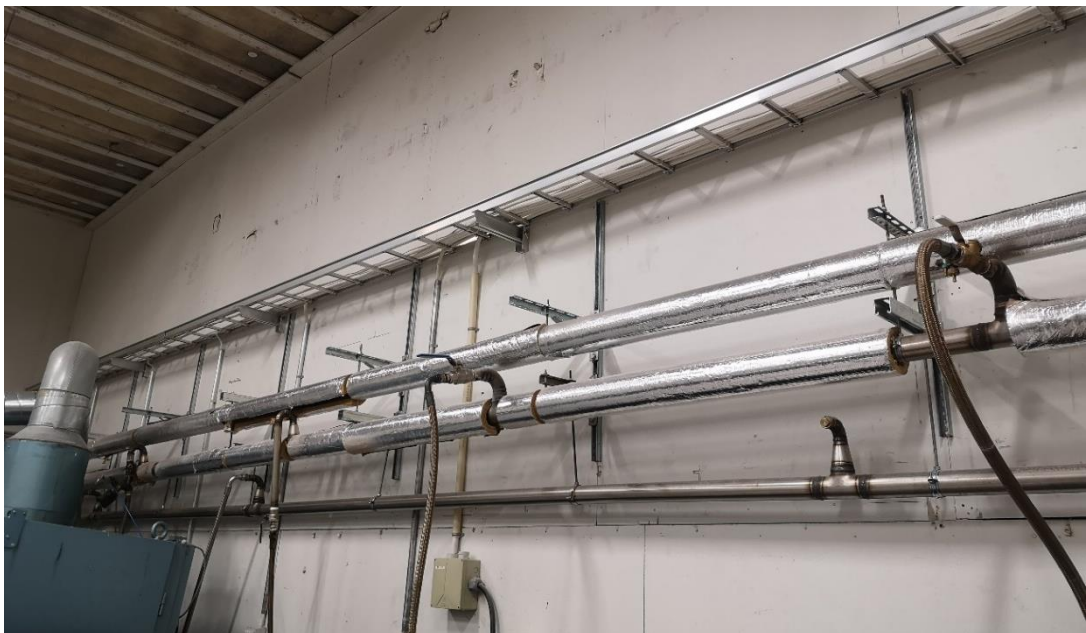
Kuva 15. Päähöyryputkisto ja lauhdevesiputkisto. Päähöyryputket on eristetty paksuilla lasivillaeristeillä.
