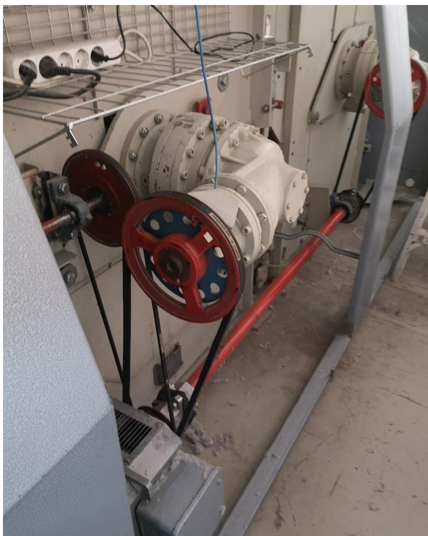
Kuva 3. Sähkömoottori välittää tehonsa kiilahihnojen ja voimansiirtoakselien kanssa telojen akseleiden kulmavaihteisiin.
