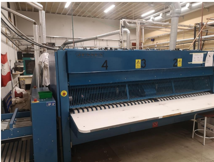
Kuva 11. Taittokone sijaitsee mankelilinjaston loppupäässä.
