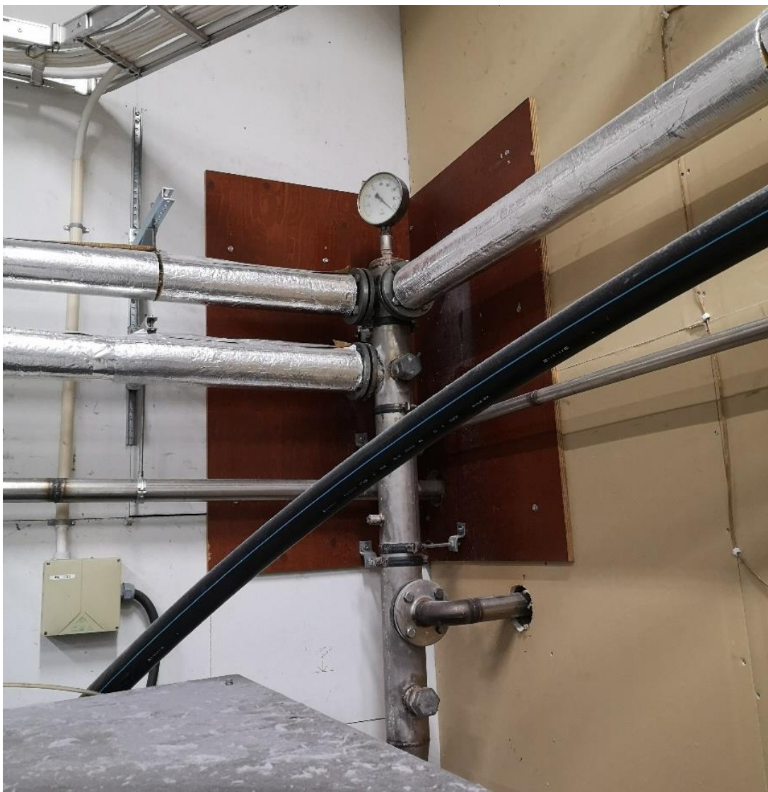
Kuva 14. Jakotukki jakaa höyryä pesulan eri kohteisiin.
