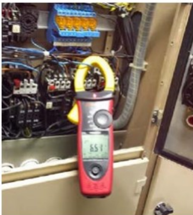
Kuva 8. Pihtimittareilla saadaan mitattua puhaltimen sähkönottoteho [3].
