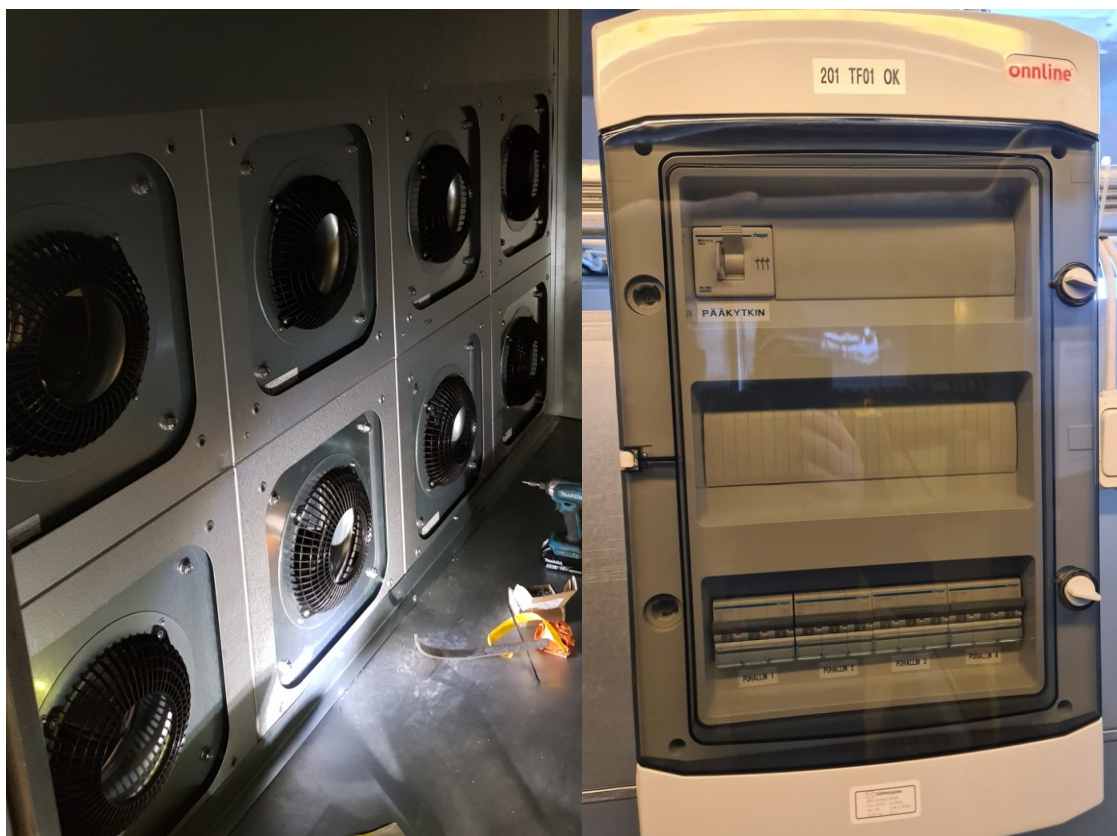
Kuva 14. Vasemmalla usean EC-puhaltimen puhallinseinä ja oikealla puhaltimien ohjauskeskus [17].
