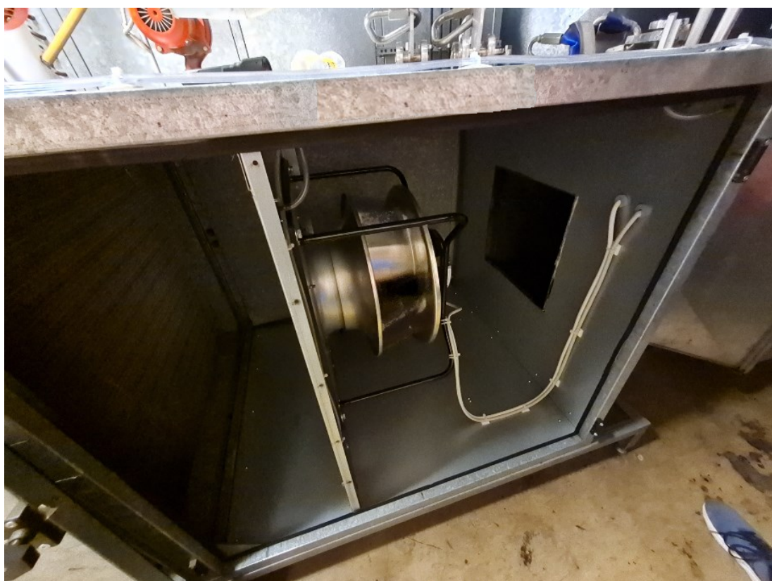
Kuva 10. Hihnakäyttöinen radiaalipuhallin uusittu EC-puhaltimella, mutta kammio avaamatta. Kammiossa pieni ulosvirtausaukko kasvattaa järjestelmän painehäviötä noin 400 Pa ja nostaa vuosittaisia sähköenergiankustannuksia 2 500 €. [17]
