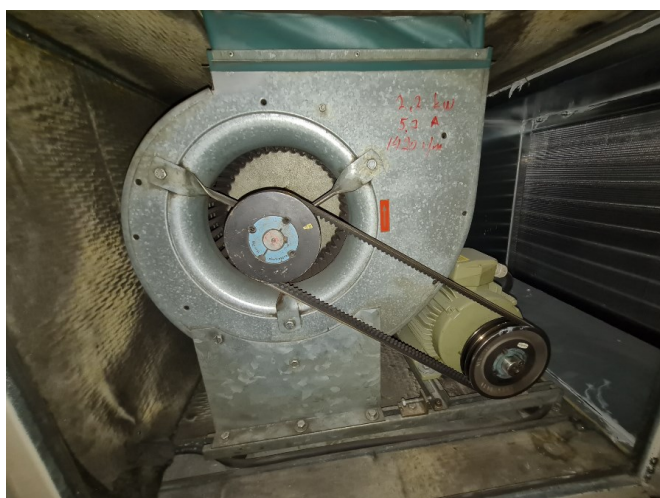
Kuva 6. Ilmastointikoneen villoitettu puhallinkammio ja puhallin [17].
