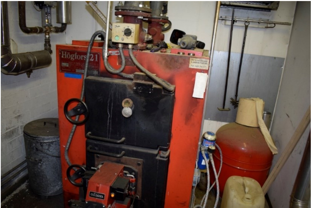
Kuva 34. Päiväkoti kakkospesän öljykattila, jossa Oilonin poltin.
