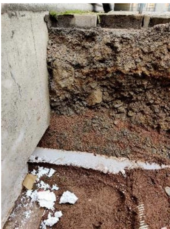
Kuva 17. Salaojaputki hienojakoisen maa-aineksesen ympäröimänä. Salaojituksen korkeusasema virheellisesti anturanpinnan yläpuolella.
