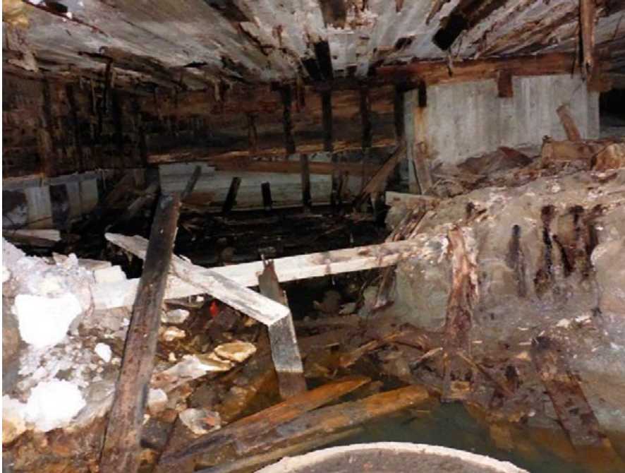
Kuva 8. Lahovaurioita betonirakenteisen ryömintätilan alapohjan muottilaudoituksessa (Pitkäranta 2016).
