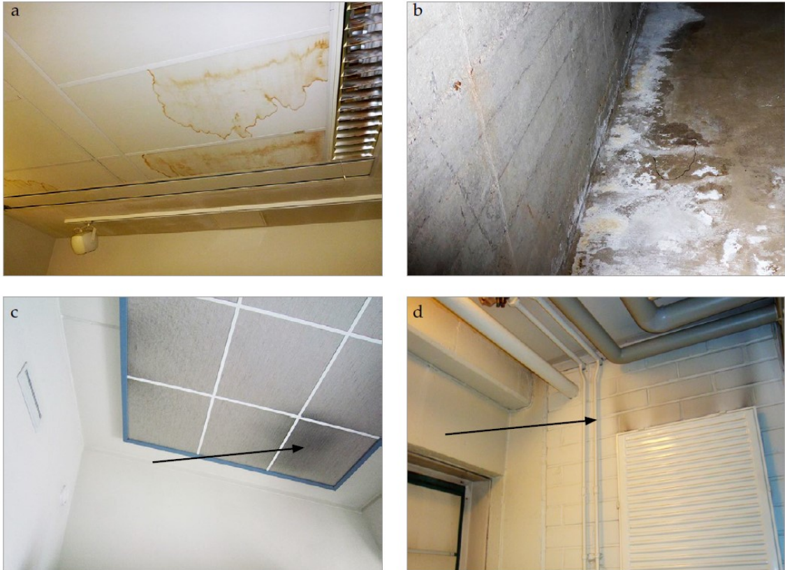
Kuva 9. a) vuotoveden aiheuttamaa värjäytymää kattolevyssä b) kalkkihärmettä putki-tunnelin lattialla c) tuloilmasuihkun aiheuttamaa likaantumista katon akustointimateriaa-lissa d) lämpöpatterin aiheuttaman ilmavirtauksen aiheuttamaa likaantumista seinäpin-nassa. (Pitkäranta 2016.)
