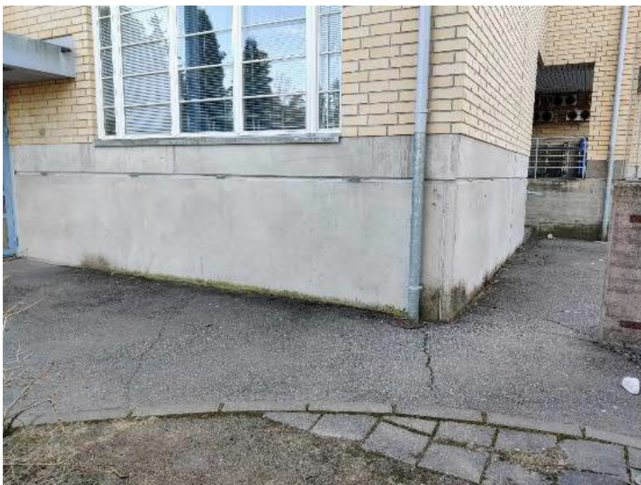
Kuva 16. Rakennuksen viereiset maanpinnan kallistukset puutteelliset. Asfaltin pinnalla sokkelin vieressä merkkejä veden lammikoitumisesta.
