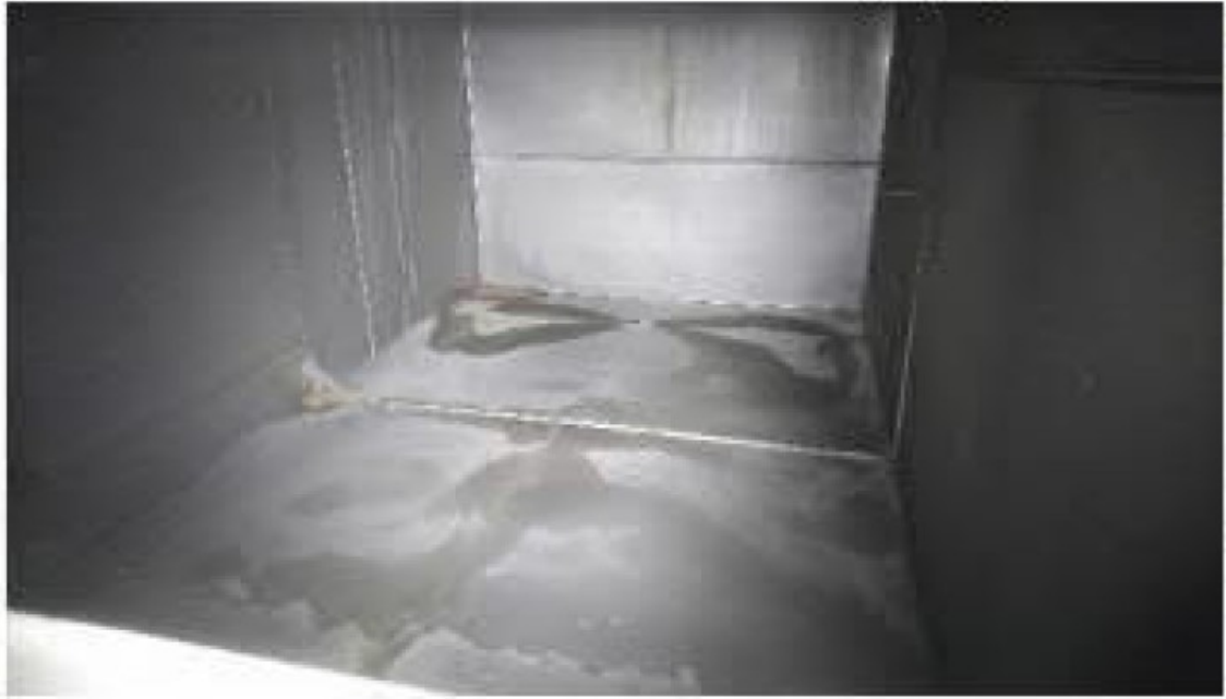
Kuva 14. Ilmanvaihtokoneen tulokammiossa esiintyvää veden lammikoitumista sekä pieniä määriä orgaanista ainetta.
