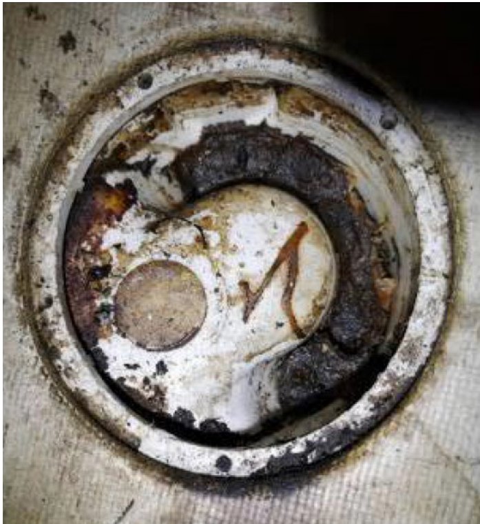
Kuva 15. Ilmanvaihtokonehuoneen lattiakaivo tukkeutunut.
