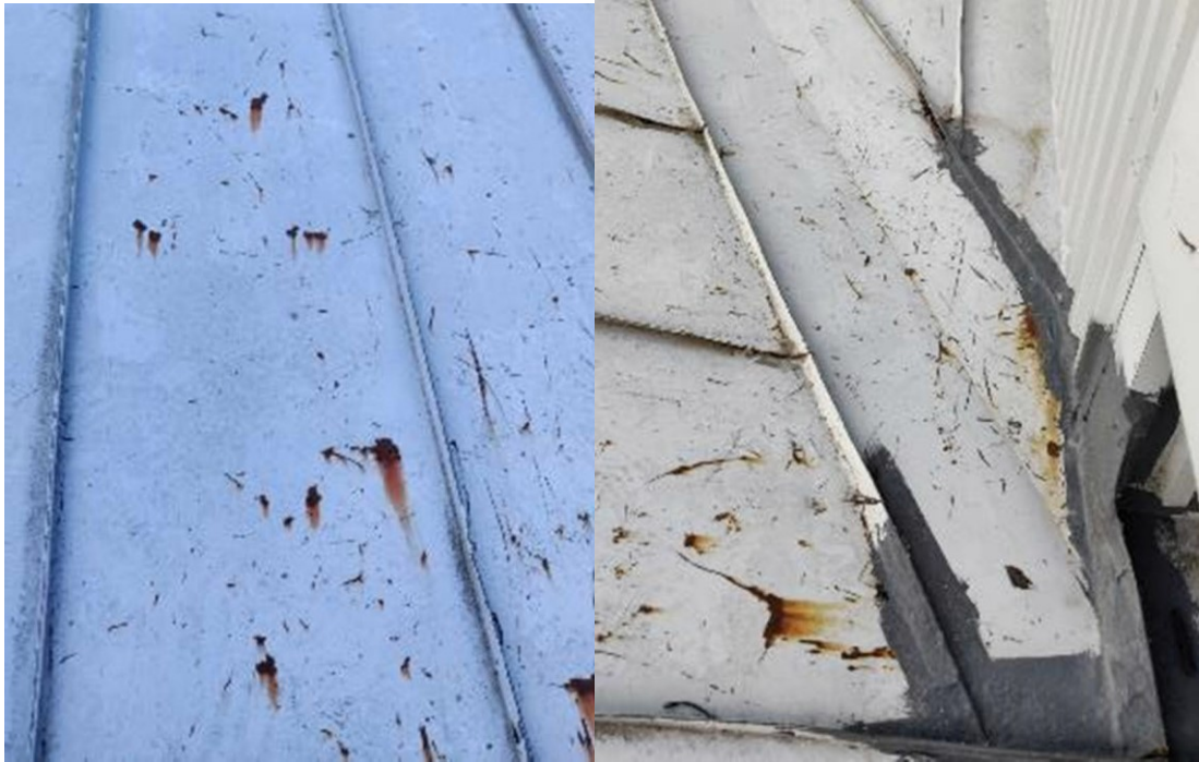
Kuva 18. a) Ruostejälkiä alkuperäisen peltikatteen pinnoilla. b) Alkuperäisen vesikatteen sauma- ja liitoskohtia paikattu useasta eri kohtaa.
