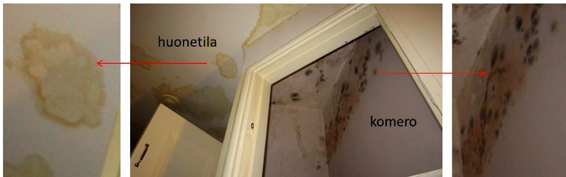
Kuva 7. Kosteusvauriojälkiä huonetilan sekä suljetun komeron kattopinnassa (Pitkäranta 2016).
