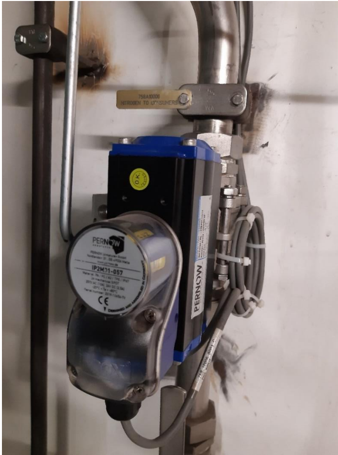
Kuva 12. Typpilinjan venttiili, jossa on aktuaattori.
