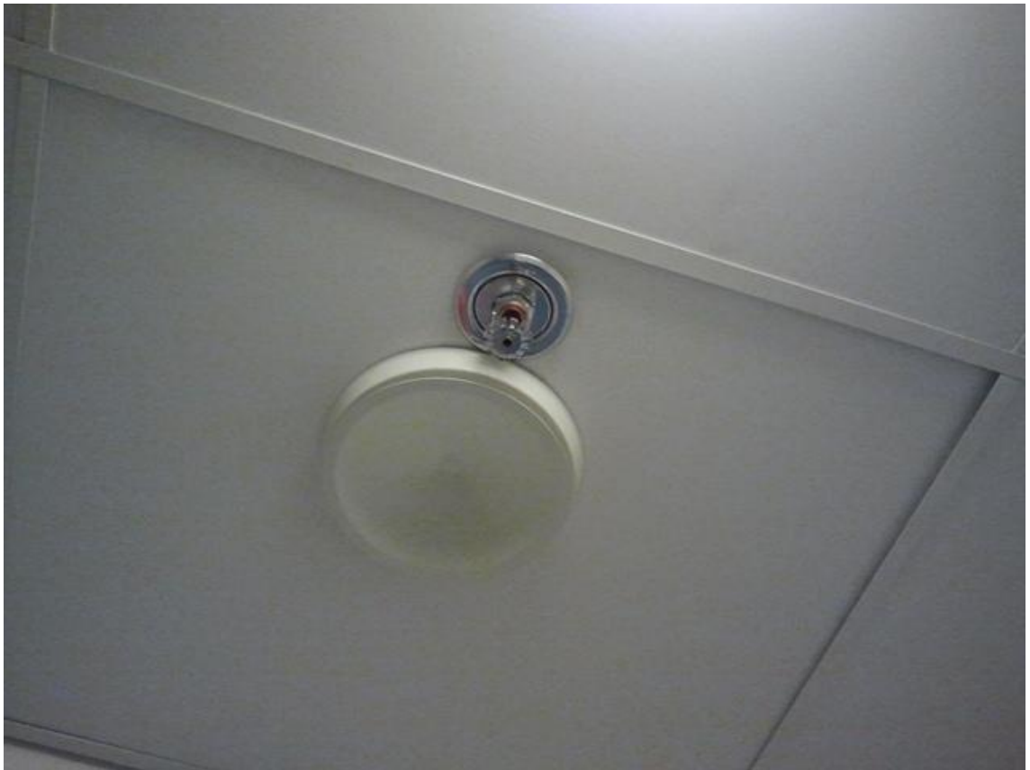
Kuva 5. Sprinklerisuutin ja päätelaite samassa ruudussa ja liian lähellä toisiaan.
