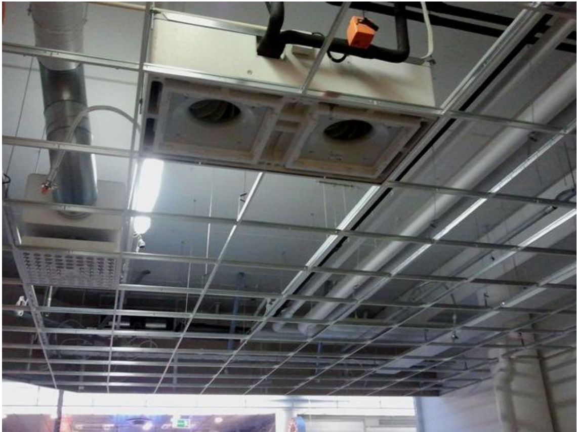
Kuva 4. Puhallinkonvektori ja ilmanvaihdon päätelaite sovitettuna ruudutettuun alakattoon. Asennustilaa on runsaasti, mikä ei kaikissa tiloissa ole aina itsestäänselvyys.
