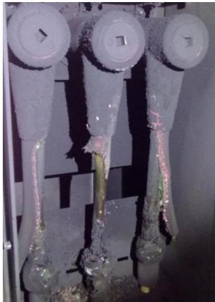
KUVA 6. Eetunkadun M1444:n rikkoutuneet päätteet
