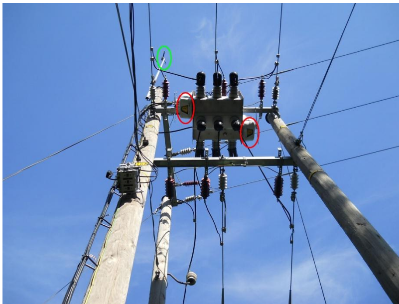
KUVA 12. Nykyinen kauko-ohjattava erotin
