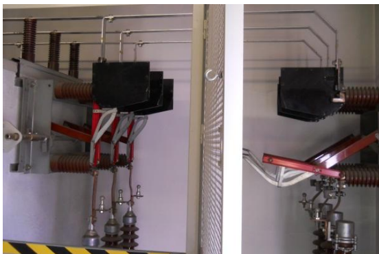
KUVA 11. M0202 KJ-kojeiston ilmaeristeiset erottimet
