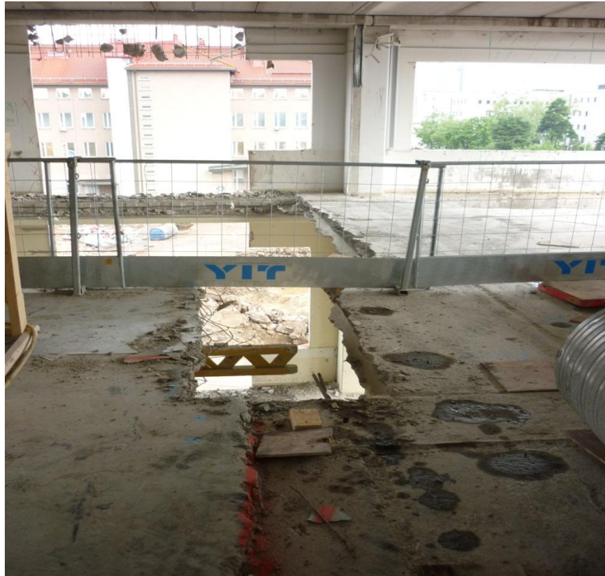
Kuva 8. Purkutyön aukko on työturvallisuusriski.
