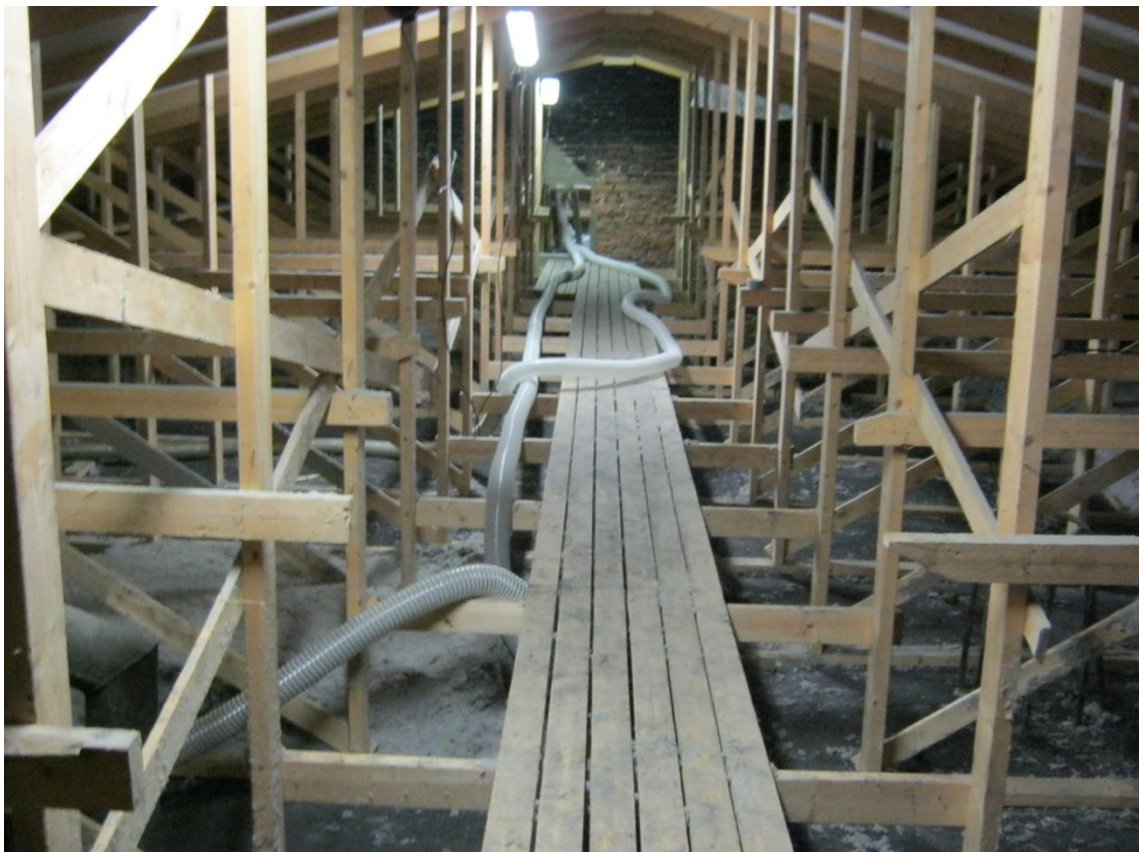
Kuva 7. Vesikaton vanhat pukkiristikot.
