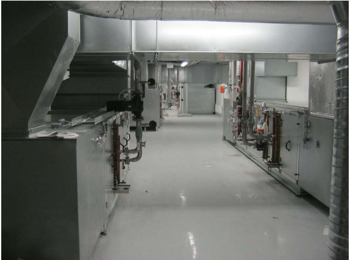
Kuva 34. IV-koneet ja -kanavat asennettuna.
