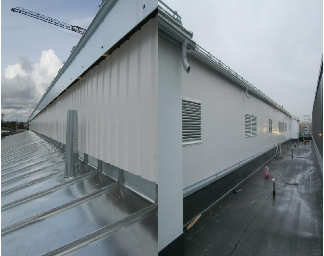
Kuva 32. Vasemmalla länsipuolen julkisivupelti. Oikealla itäpuolen sadetakkipelti ja IV-kanavien säleiköt.
