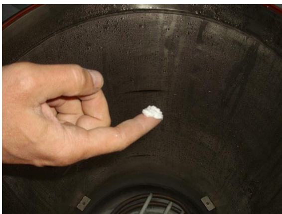
KUVA 10. Saostumaa voi kertyä vastuksiin reilujakin määriä johtuen käytetyn veden epäpuhtauksista. (Kuva: Kimmo Färm 2008)
