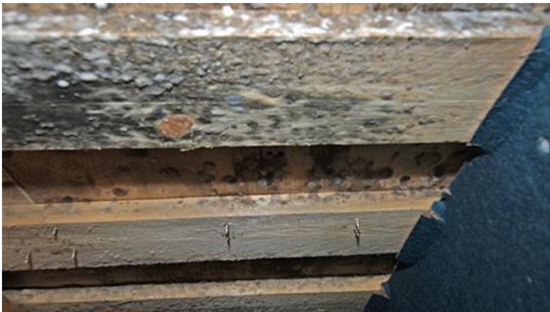
Kuva 2. Homevaurio näkyy laudoituksessa värimuutoksena ja kasvustona. (Yleisradio www-sivut 2012)
