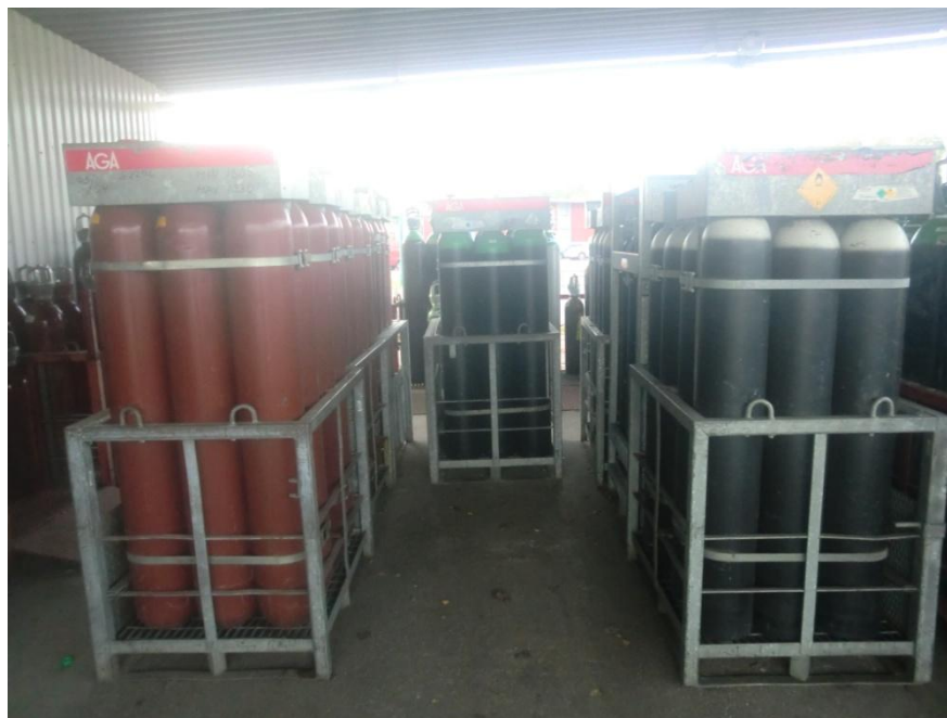
Kuva 6. Kaasupaketteja; erona koreihin, että kaasupullot on liitetty sarjaan.
