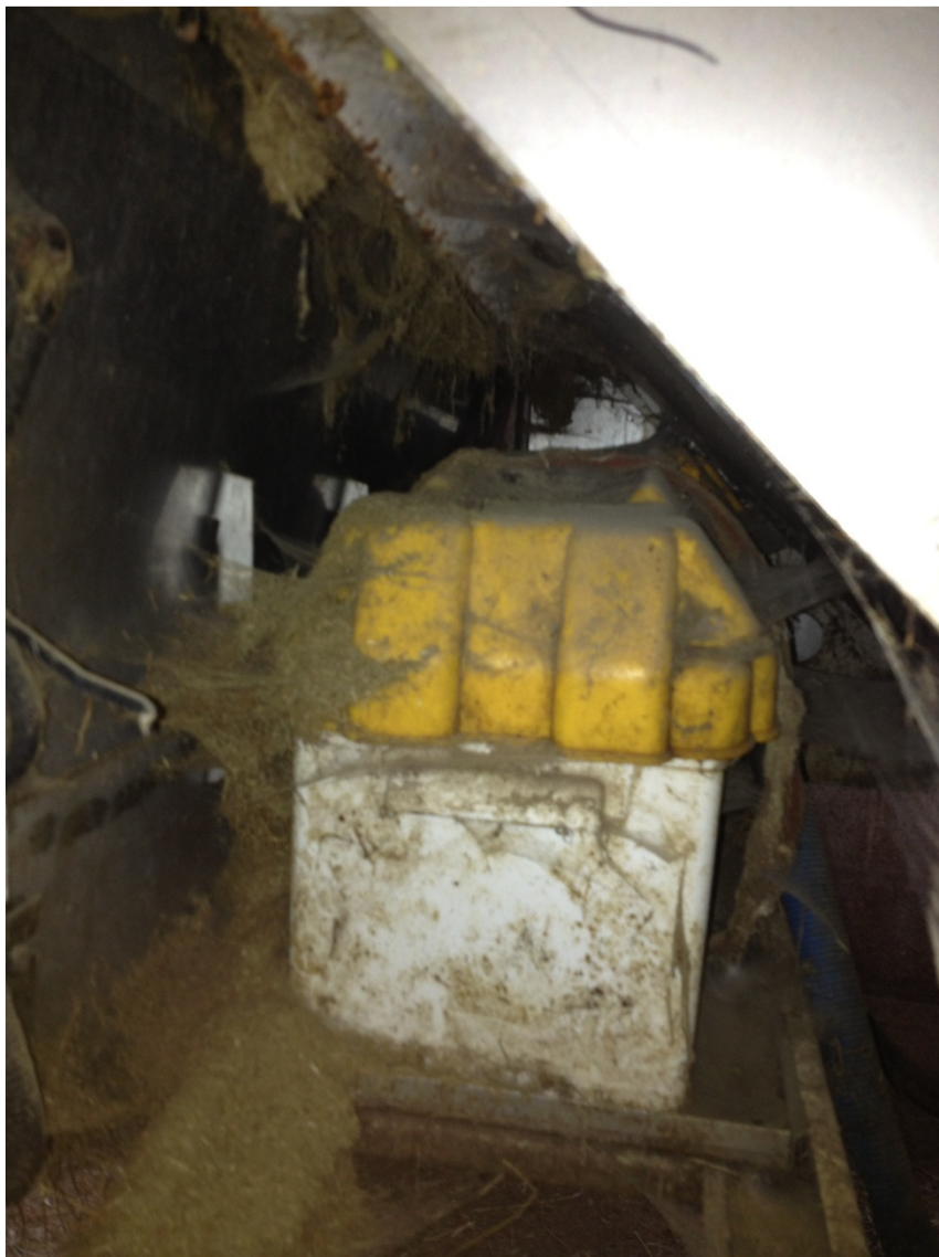
Kuva 7. Kiskoruokkijan pölyinen akkukotelo.
