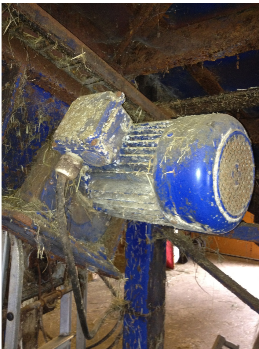
Kuva 5. Pölyinen täyttöpöydän sähkömoottori rehuvarastossa alttiina kosteusrasitukselle.
