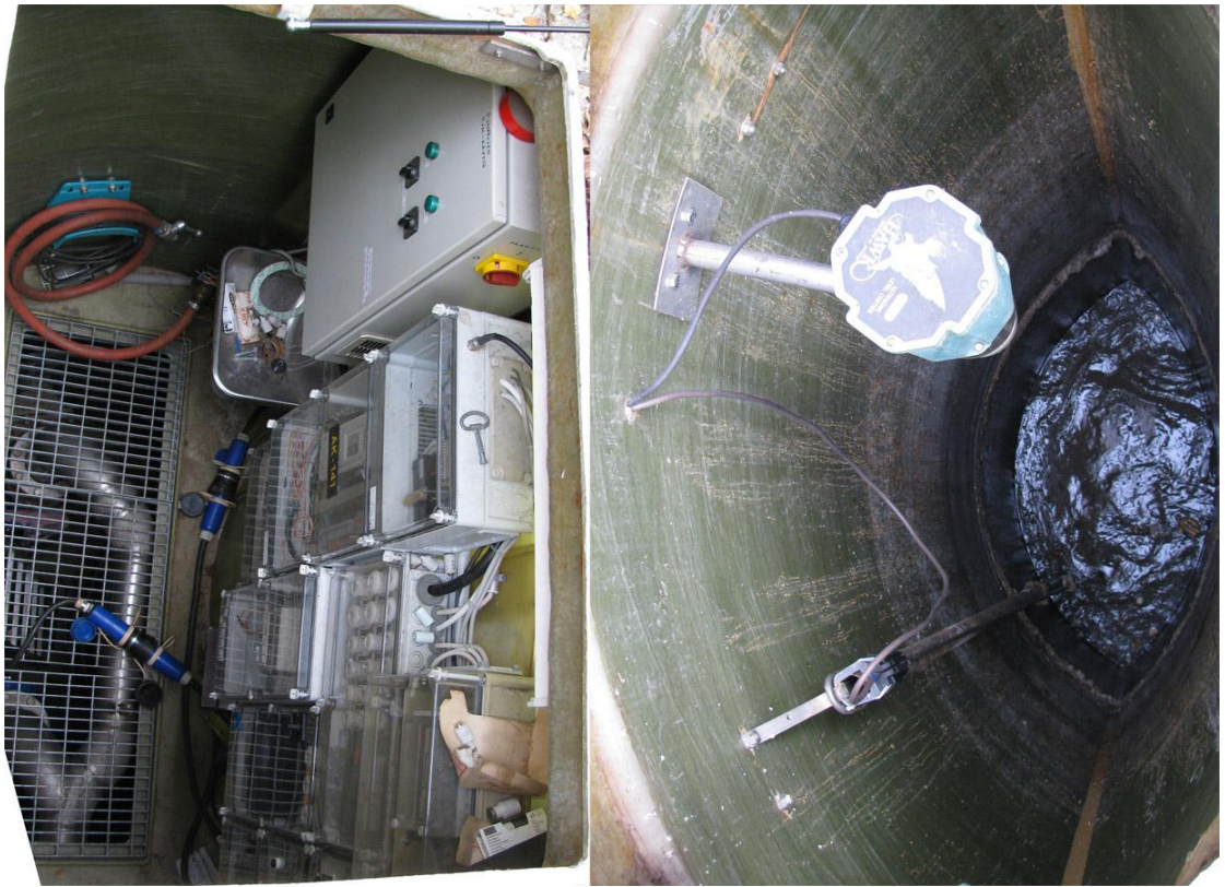
KUVA 11. Porrassalmentien turvapumppaamo (Hiltunen 2012).
