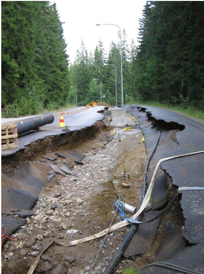
Kuva 25. Vesijohtovaurio Kaupinkadulla. (Tampereen Vesi)
