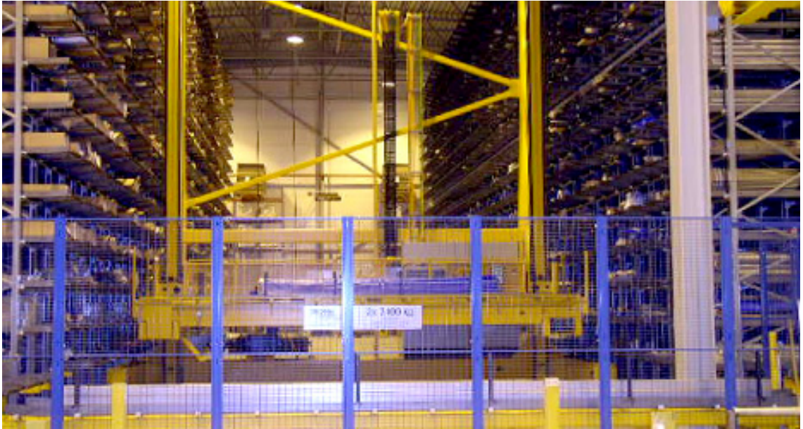
Kuva 7. Automaattivarasto, BE-Group Lahti, terästangoille ja teräslevyille. ( www.algoltechnics.fi )
