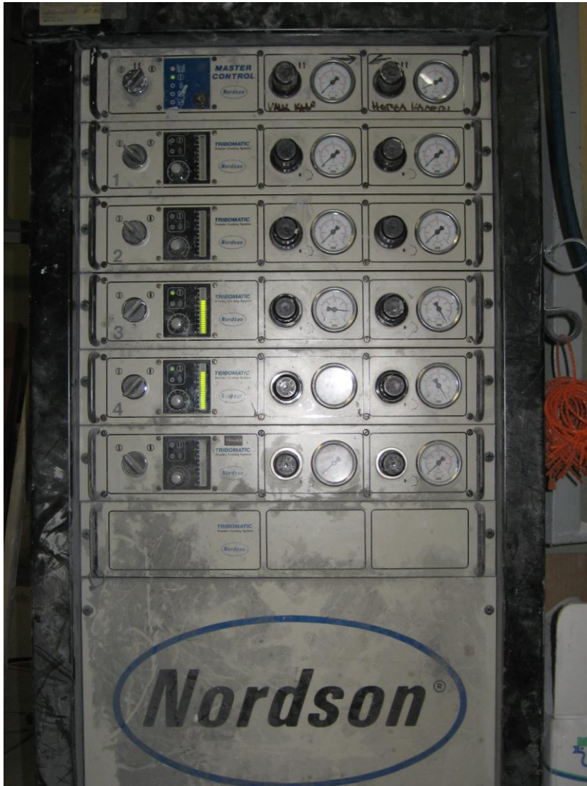
KUVA 4. Mever Oy:n jauhemaalaukskaapin ohjausyksikkö
