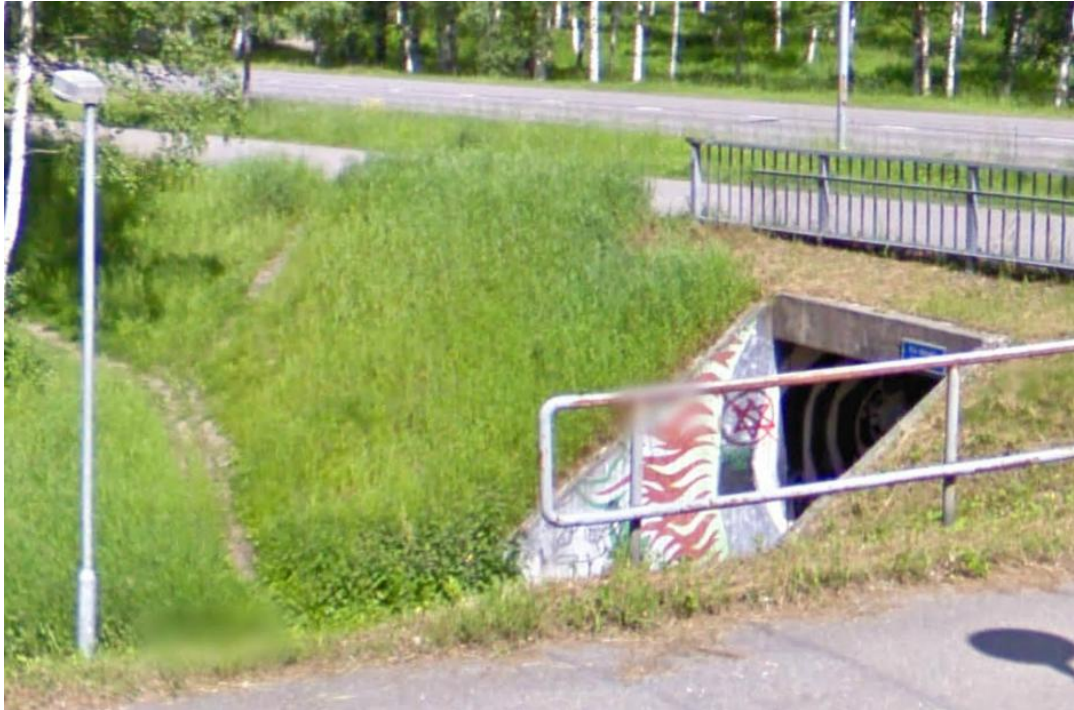
Kuva 22. Skinnarilankadun alitukselta Kaartinkadun kohdalla puuttuu yhteys Skinnarilankadun kevyen liikenteen väylälle (3)
